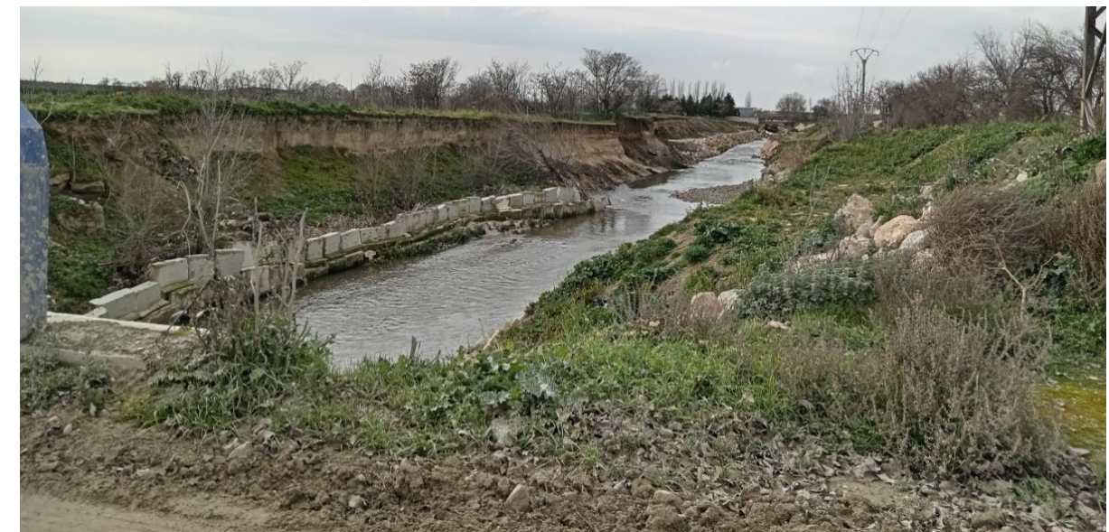
Figura 12. Erosión en el arroyo Culebro. Fotografía tomada en campo (16/01/2024)
