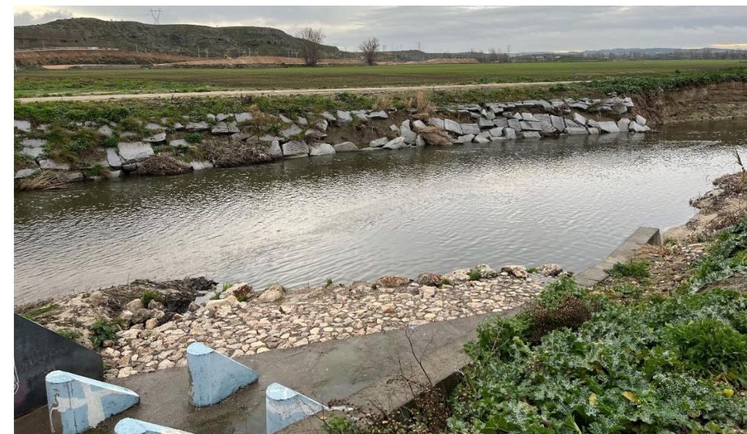
Figura 4. Escollera aguas abajo del puente de la autovía M-45. Fotografía tomada en campo (16/01/2024)
