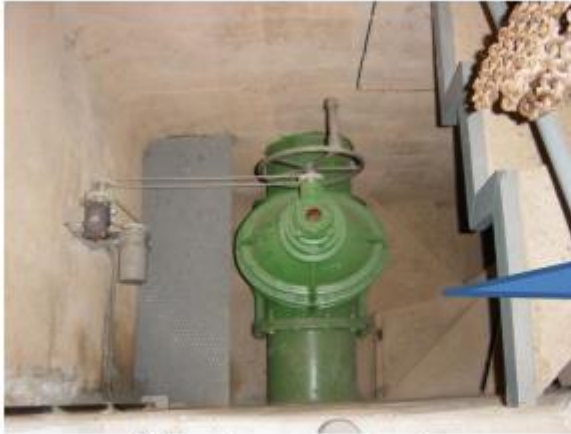
Válvula aguas abajo
