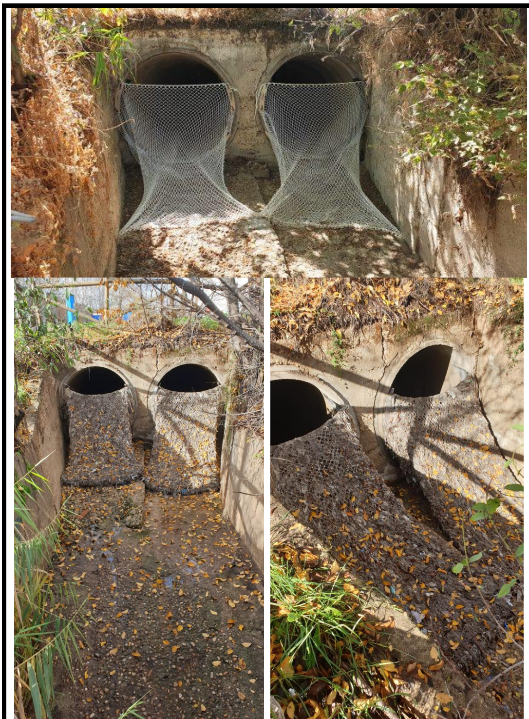
La «Sociedad Española de Ornitología» (SEO BirdLife) gestiona la instalación de 2 cuellos (acero inoxidable AISI-316) para colectores de 1.500 mm de diámetro con 2 cestas Tecno-Grabber®, en el sistema de saneamiento de Coslada (Madrid), que vierten al río Jarama. Cortesía de Tecnoconverting.
