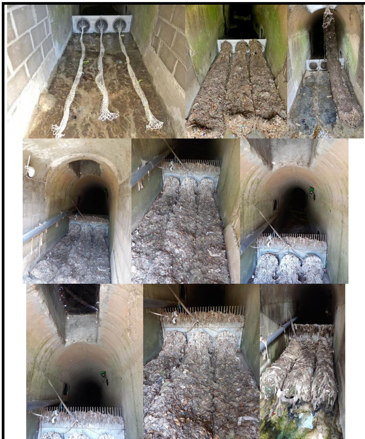
Evolución en la instalación de 3 cestas Tecno-Grabber® (inicialmente sin rejas de retención y posteriormente con rejas de retención en la zona superior) y su monitorización [Sensor de nivel por ultrasonidos (US) sin contacto + Registrador de datos SOFREL LT-US (Data Logger)] en un colector del sistema de saneamiento de Sabadell (Barcelona). Río Ripoll. Cortesía de la Agencia Catalana del Agua (ACA), LACROIX SOFREL y Tecnoconverting.
