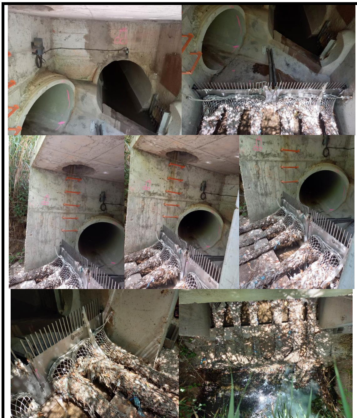
Instalación de 6 cestas Tecno-Grabber® y su monitorización [Sensor de nivel por ultrasonidos (US) sin contacto + Registrador de datos SOFREL LT-US (Data Logger)] en un colector del sistema de saneamiento de Sant Fruitós de Bages (Barcelona). Río d'Or. Cortesía de la Agencia Catalana del Agua (ACA), LACROIX SOFREL y Tecnoconverting.
