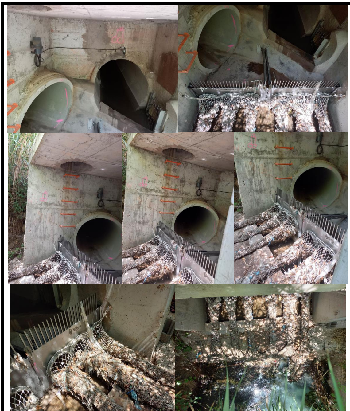
Instalación de 6 cestas Tecno-Grabber® y su monitorización [Sensor de nivel por ultrasonidos (US) sin contacto + Registrador de datos SOFREL LT-US (Data Logger)] en un colector del sistema de saneamiento de Sant Fruitós de Bages (Barcelona). Río d'Or. Cortesía de la Agencia Catalana del Agua (ACA), LACROIX SOFREL y Tecnoconvertint.
