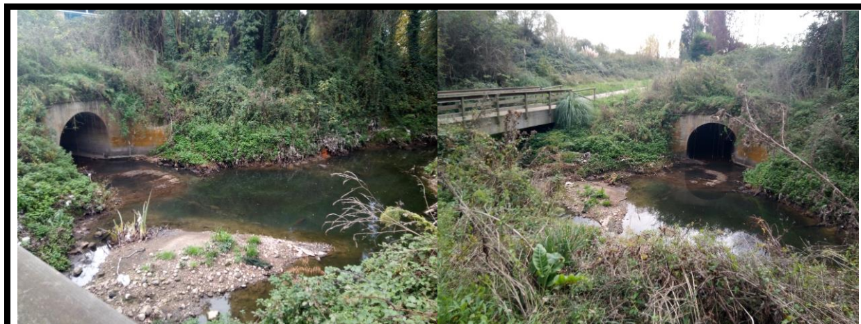
Punto de vertido del desbordamiento del sistema de saneamiento asociado a una Infraestructura de Regulación de Aguas Residuales (IRAR), Tanque de Tormentas, al DPH. España. Cortesía de TRAGSATEC.
