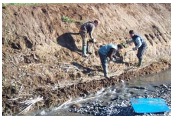
Instalación de fajina viva para la protección de la base del talud.
