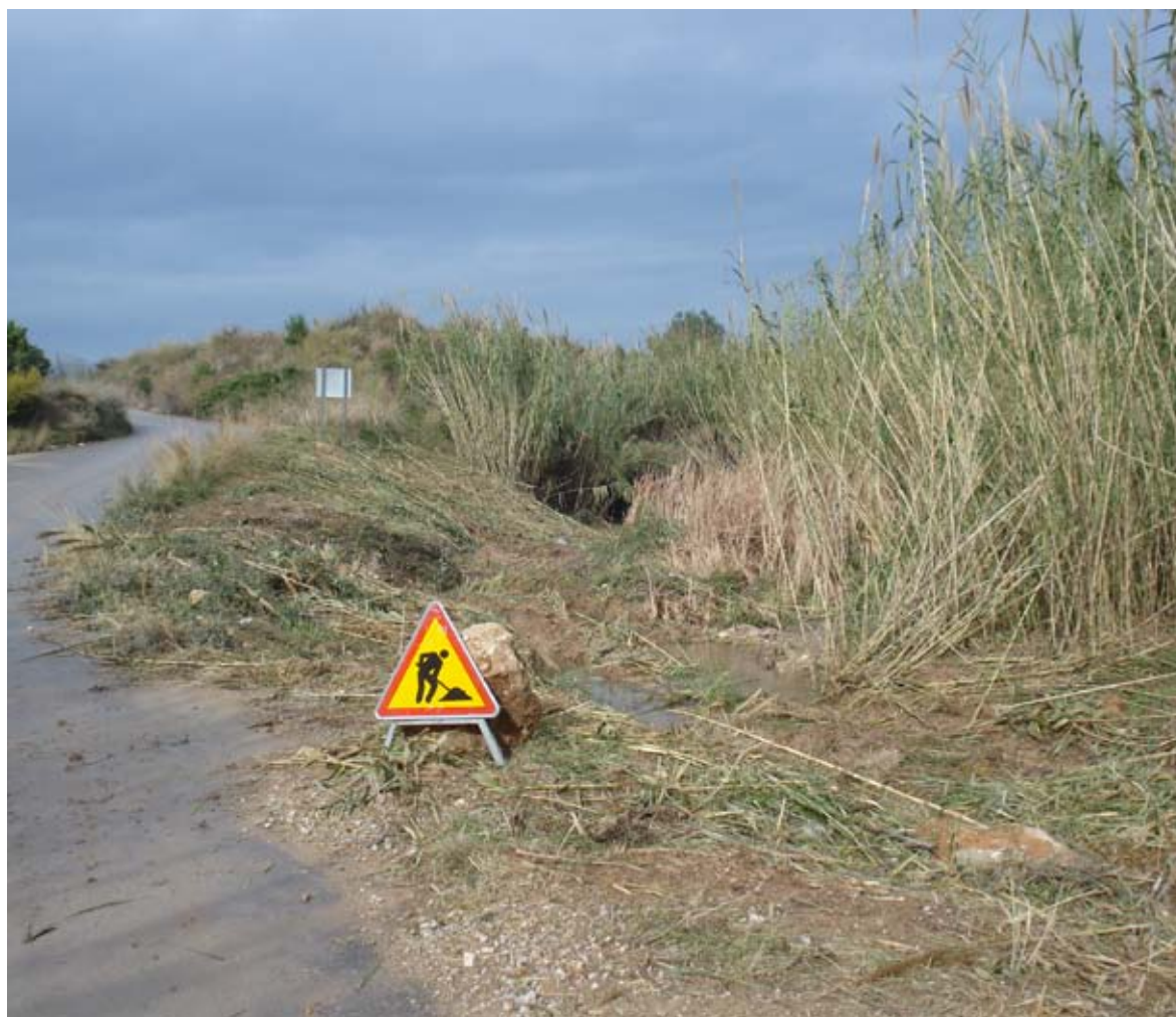
Obstrucción y alteración de la funcionalidad de las infraestructuras públicas próximas a cauces invadidos por A. donax .
