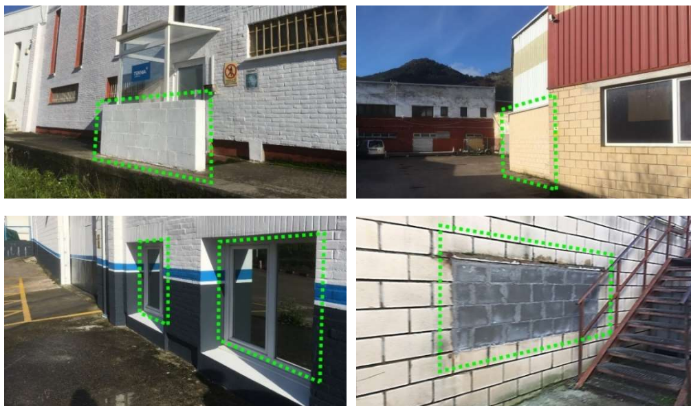
Fig. 44. Ejemplo de medidas de autoprotección en el Polígono Industrial de Marrón (Ampuero, Cantabria): muretes de protección, antepechos, cristales blindados y sellado permanente de huecos.
