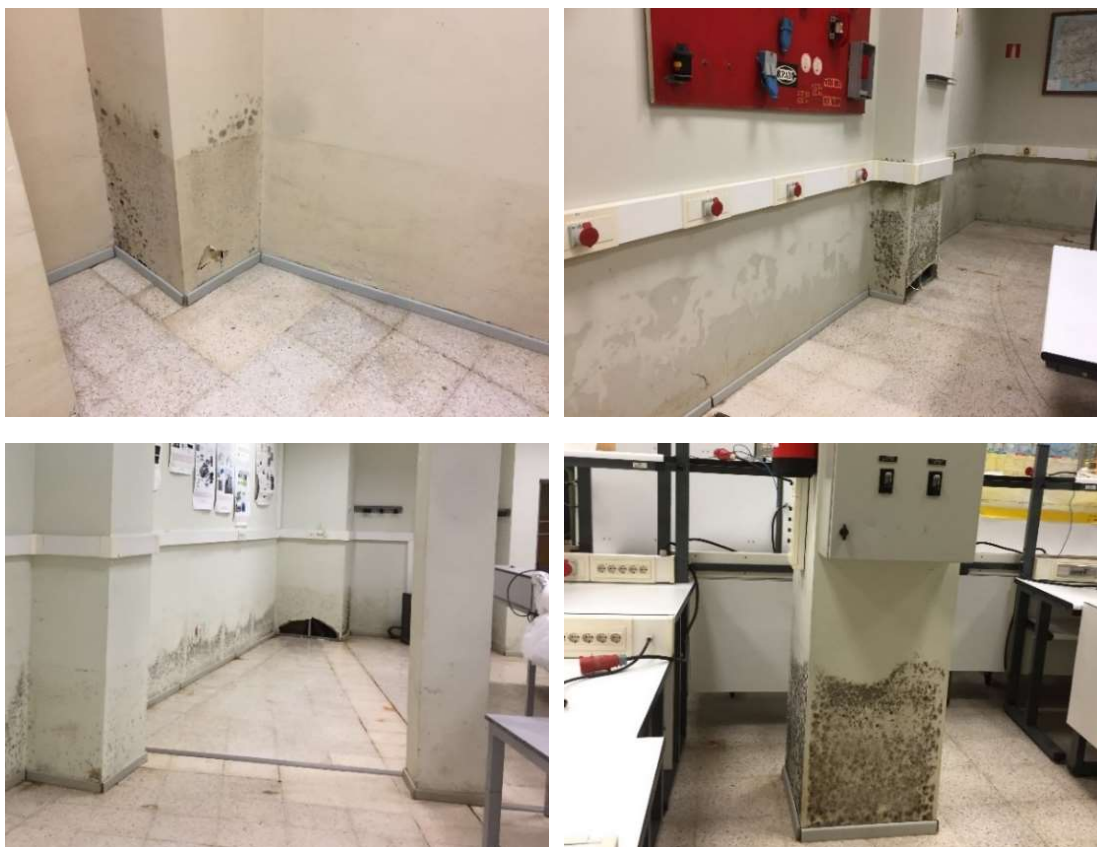
Fig. 24: Daños en patinillos de instalaciones tras la inundación en junio de 2018. Universidad de Oviedo.
