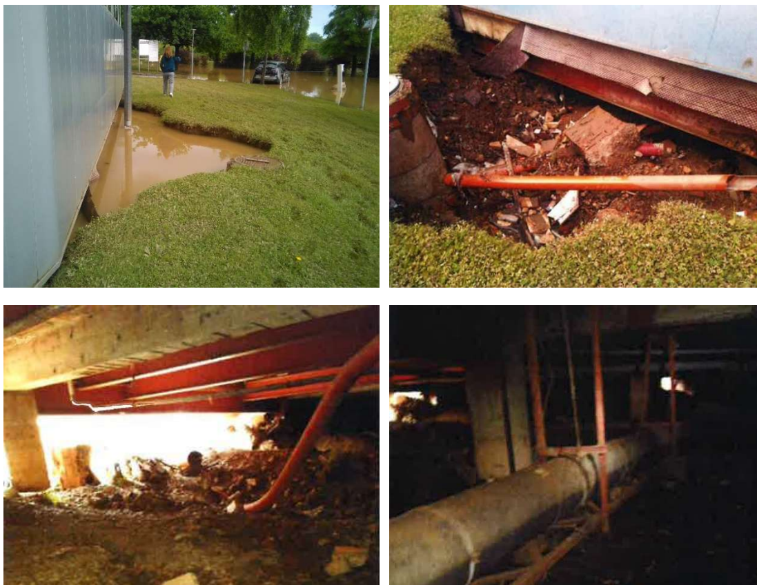
Fig. 23: Daños en cámara bajo forjado sanitario tras la inundación en junio de 2018. Universidad de Oviedo.
