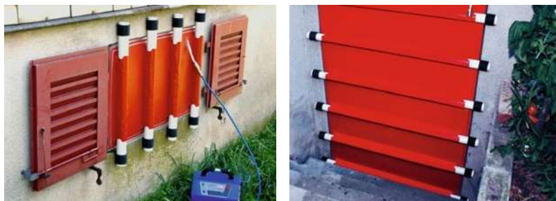
Fig. 43: Ejemplos de sellado temporal. Flood proofing in urban areas. 2019.
