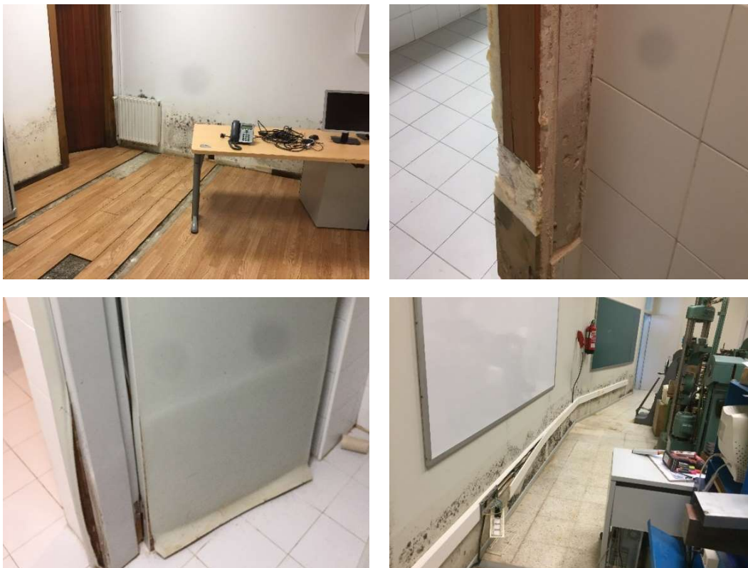
Fig. 25: Daños en pavimentos, paramentos, puertas e instalaciones tras la inundación en junio de 2018. Universidad de Oviedo.
