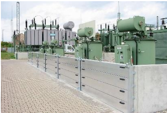
Fig. 26: Ejemplo de elemento crítico protegido mediante barreras temporales desmontables. Flood Control International.
