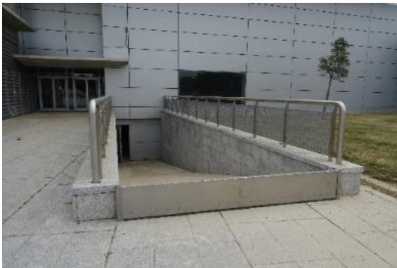
Fig. 47: Ejemplo de barrera temporal desmontable en accesos. Ciudad Deportiva de Tafalla (Navarra). Grupo Tragsa.
