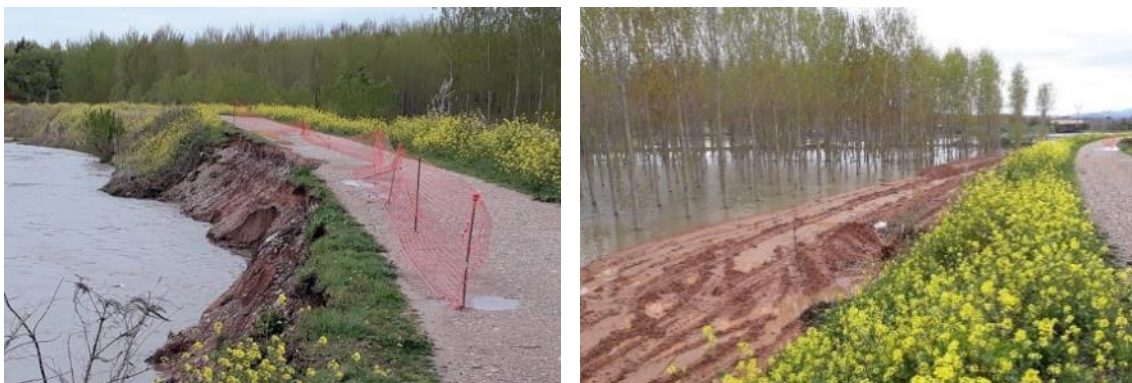
Fig. 33: Ejemplo de erosión (izquierda) y estabilización (derecha) en la margen del río Alhama en Alfaro (La Rioja). Grupo Tragsa.
