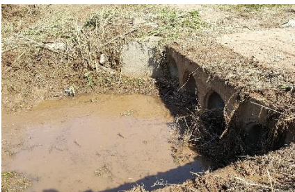
Fig. 71: Inundaciones en Sant Llorenç (Mallorca) agravadas por taponamiento de encauzamientos subterráneos. Grupo Tragsa.
