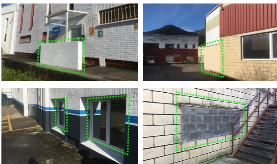
Fig. 32. Ejemplo de medidas de autoprotección en el Polígono Industrial de Marrón (Ampuero, Cantabria): muretes de protección, antepechos, cristales blindados y sellado permanente de huecos.
