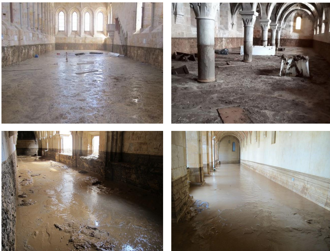
Fig. 29: Inundación en 2018: daños en refectorio, sala de conversos, claustro gótico y claustro herreriano. Monasteriohuerta.org
