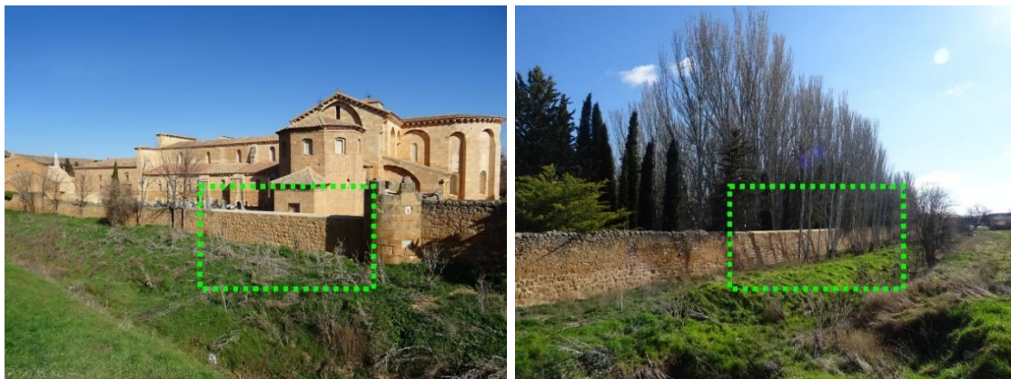
Fig. 37: Puntos de rotura en el muro sudoeste en 2015 (cementerio) y 2018 (chopera).
