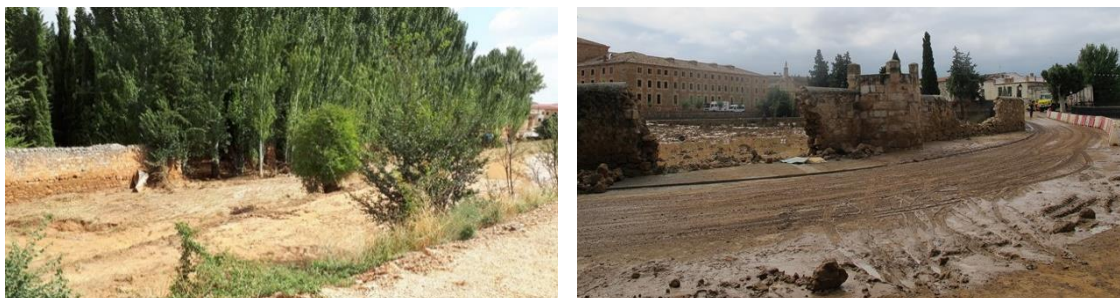
Fig. 12: Inundación de septiembre de 2018: rotura del muro adyacente al barranco del Tejar (entrada de agua) y del muro del paseo de la Estacada (salida de agua). Monasteriohuerta.org
