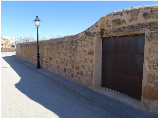
Fig. 39: Compuerta de evacuación.
