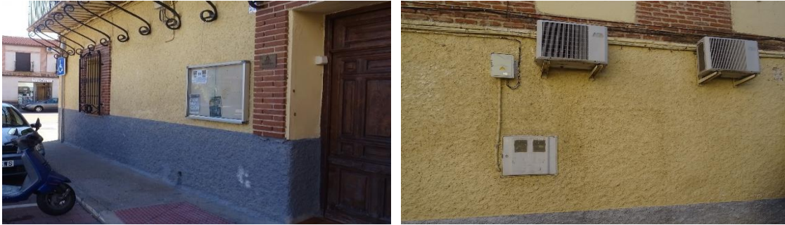
Fig. 25: Ayuntamiento de Cebolla: fachada de enfoscado, huecos (bajantes), rejas fijas, instalaciones vulnerables.
