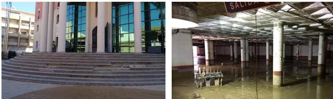
Fig. 15: Daños en el edificio del Ayuntamiento por la inundación de septiembre de 2019. Ayuntamiento de Los Alcázares.
