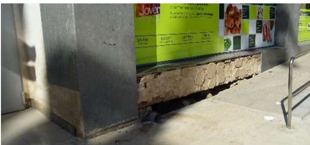
Fig. 19: Principales puntos de entrada de agua.
