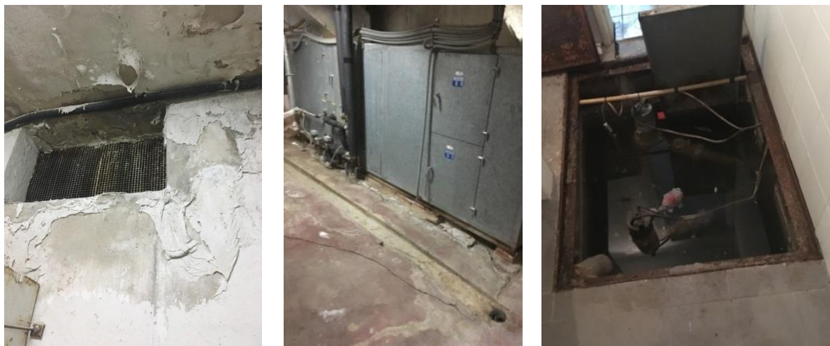
Img. 12. Humedades en paso de ventilación, canalización en suelo, y punto de bombeo.
