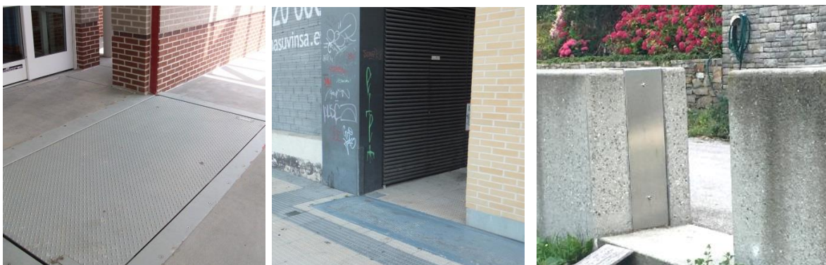
Img.17. Barreras metálica hidráulica y esperas de barreras temporales.
