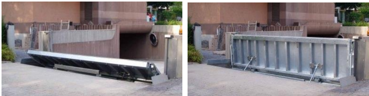
Img.16. Barrera temporal de contención. Compuerta neumática.
