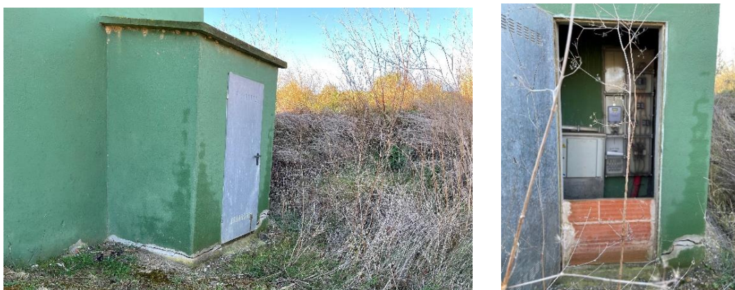
Figura 9. Anexo a la edificación principal. Cuadros eléctricos
