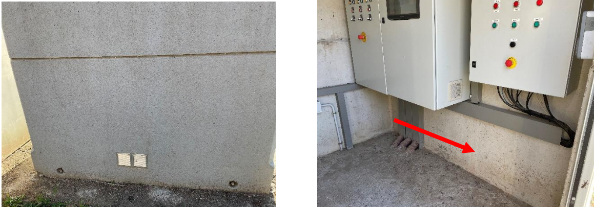
Figura 13. Casetas en zona potencialmente inundable. Rejilla en zona baja. Cuadros eléctricos, a cota 0.6 m desde el suelo (el más bajo).
