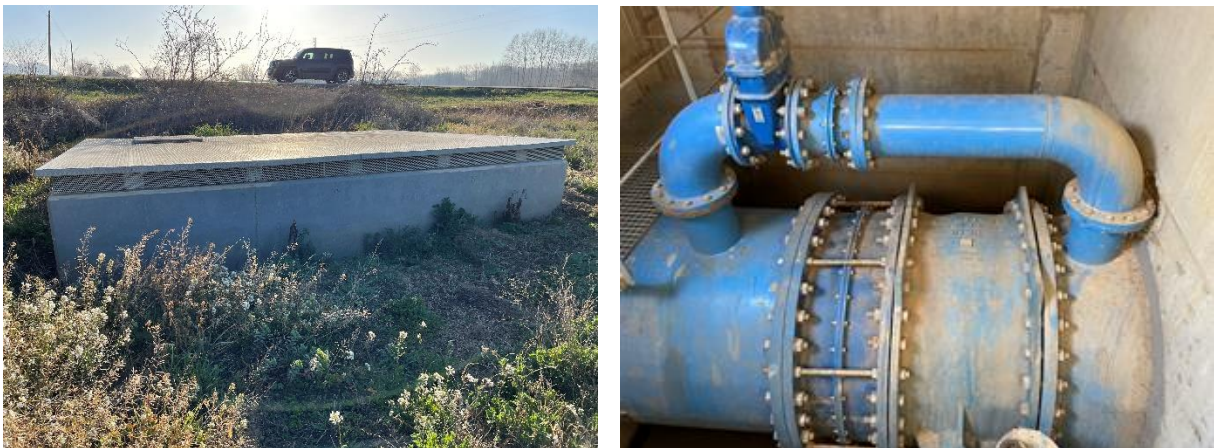
Figura 14. Cámara en Verges. Válvula DN 1400, PN 10, con bypass.
