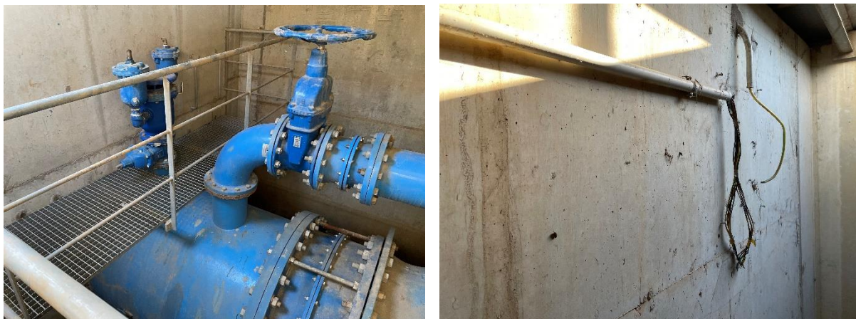
Figura 15. Ventosa y by-pass. Zona donde se ubicaba el cuadro eléctrico.
