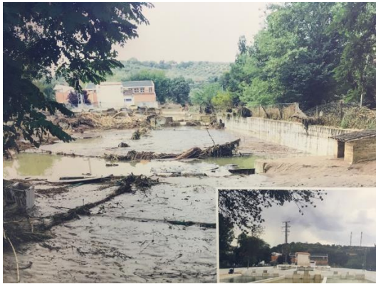
Foto 3. Inundación de 2018 en la instalación piscícola (fase B)
