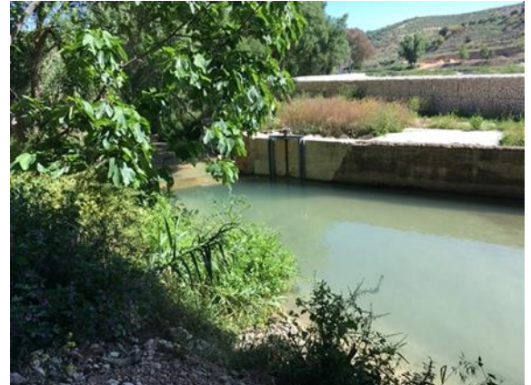
Foto 19. Zona elevada por muros y elementos auxiliares, entre el murete y el gavión, que generan una limitación importante a la sección del río
