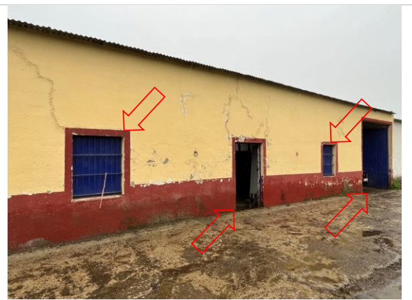
Foto 7. Puntos de entrada del agua. Fachada sur construcción garaje-almacén
