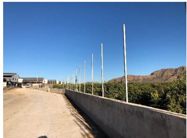
Foto 18. Muro reconstruido tras la inundación. Zona perimetral este
