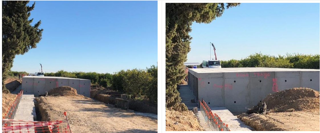
Foto 20. Obra de drenaje formada por marcos prefabricados de hormigón (Carretera RM-F29)
