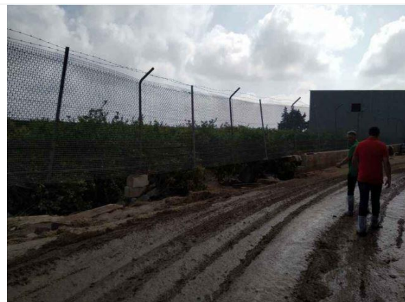
Foto 17. Muro perimetral tras la inundación del 2019
