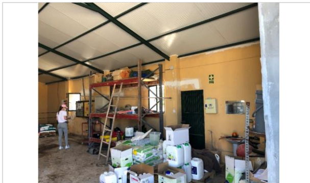
Foto 26. Posibles puntos de entrada del agua a la nave de riego (Puerta muros norte)
