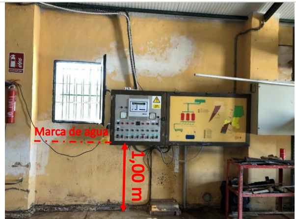
Foto 27. Cuadros eléctricos dentro de la nave de riego
