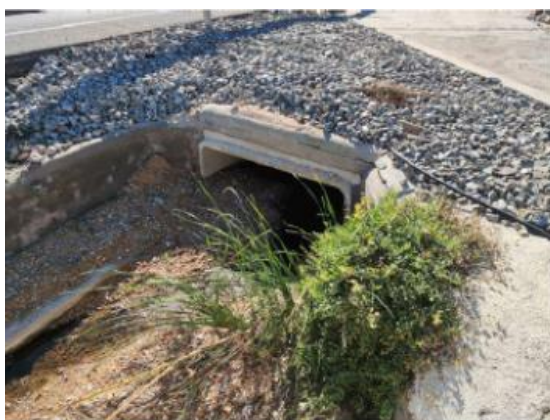
Foto 37. Obstrucción a la salida del marco al D-7
