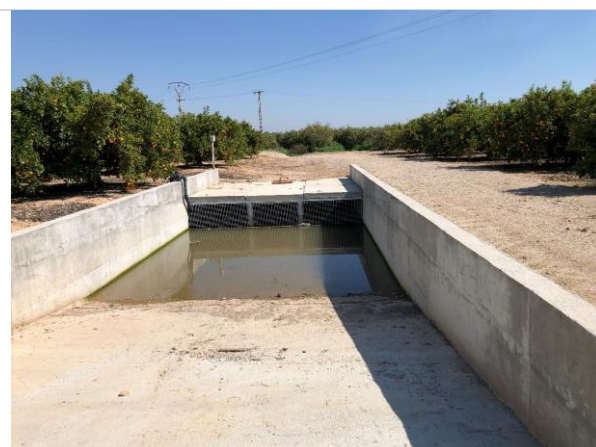
Foto 32. Sistema de drenaje superficial en canal (bombeo)
