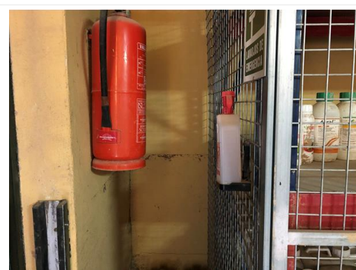
Foto 20. Marca en la pared del nivel del agua
