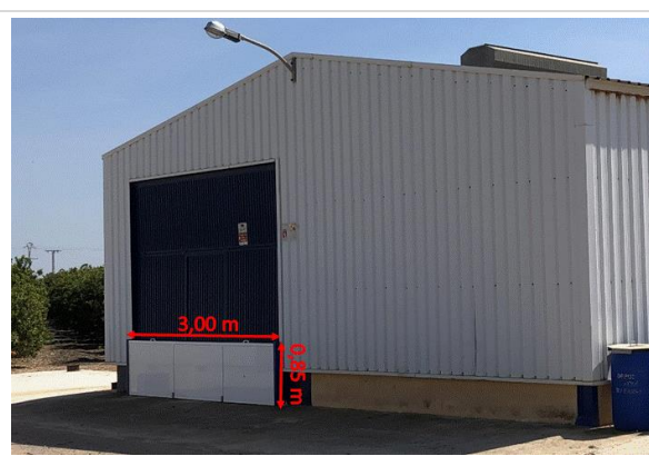
Foto 29. Compuerta anti-inundación desaladora
