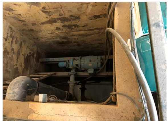
Foto 7. Pozo de bombeo a la red de riego
