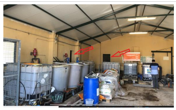
Foto 27. Posibles puntos de entrada del agua a la nave de riego. Puertas
