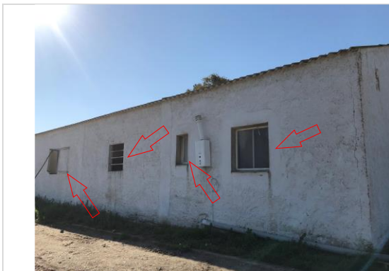
Foto 8. Posibles puntos de entrada del agua al edificio almacén y vestuario (ventanas del muro oeste)
