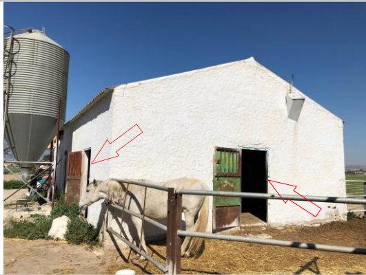
Foto 10. Posibles puntos de entrada del agua al corralito (puertas muro este y muro norte)
