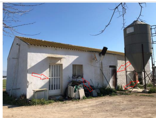
Foto 9. Posibles puntos de entrada del agua al edificio almacén y al corralito (puertas y ventana del muro este)
