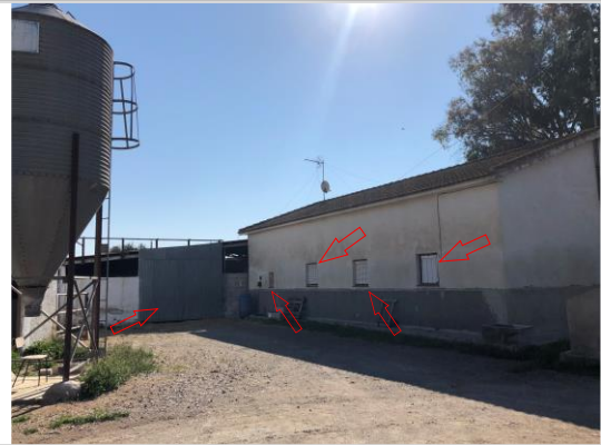
Foto 11. Posibles puntos de entrada del agua a la vivienda (ventanas del muro este) y al corral cubierto (portón de entrada)
