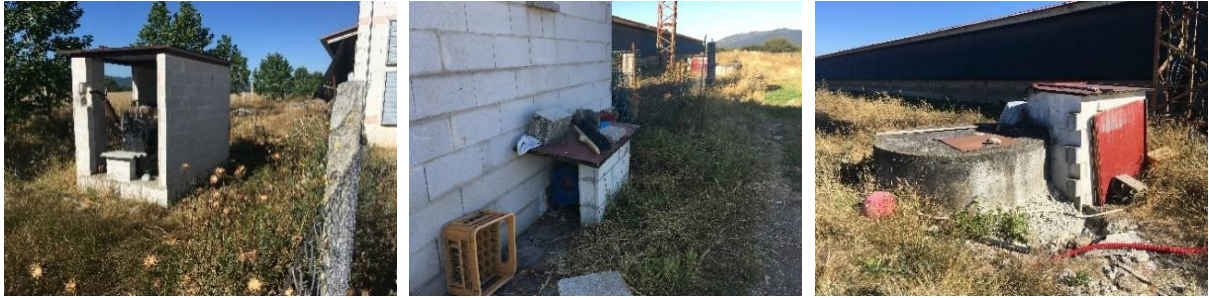
Foto 4. Equipos susceptibles de sufrir daños por inundación
