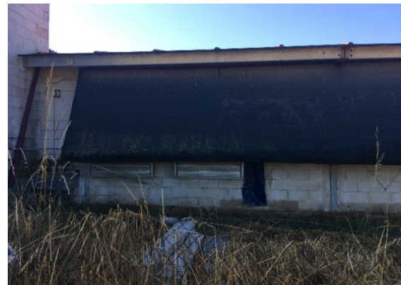
Foto 7. Pared de bloque sin revestimiento. Elementos de ventilación
