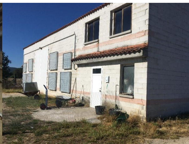
Foto 9. Portón y puerta a proteger. Elementos de ventilación muy bajos junto al portón. La línea superior de la banda rojiza está a 80 centímetros sobre la cota del edificio (1,30 metros sobre el terreno). El alféizar de la ventana, a 90 centímetros, está al límite de la T500.
