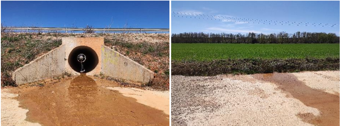
Foto 4.1. Drenaje de la autovía A-11 directamente hacia las parcelas agrarias (Fuente: titular explotación)
