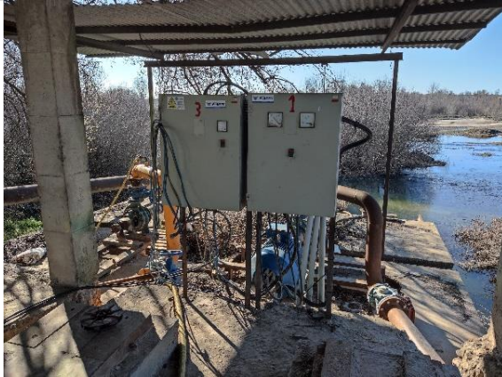
Foto 1. Tuberías y bombas de captación para el agua de riego
