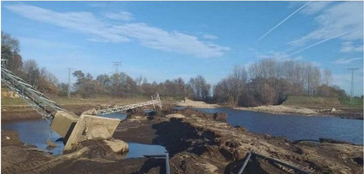
Foto 7. Daños provocados por la inundación del año 2019
