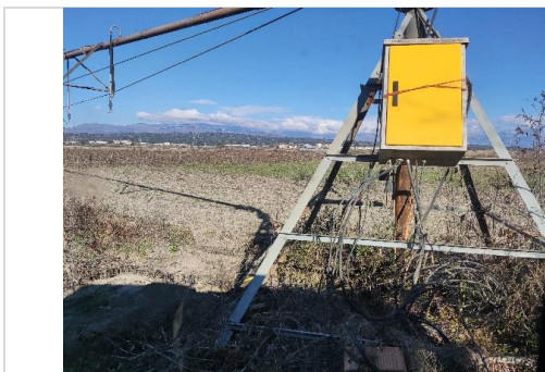
Foto 9. Cuadros eléctricos de los pivotes elevados
