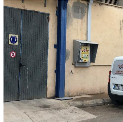
Foto 3. Cuadros eléctricos exteriores sobre el muro de la nave principal
