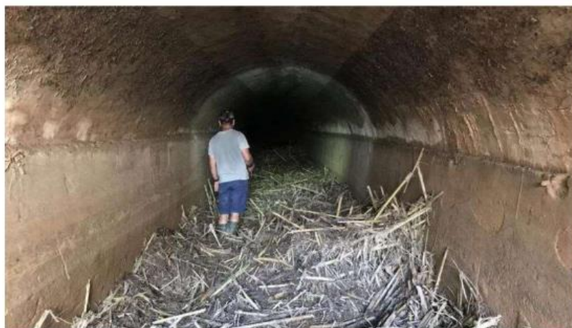
Foto 8. Cañas acumuladas en el tramo subterráneo abovedado de la RAC
