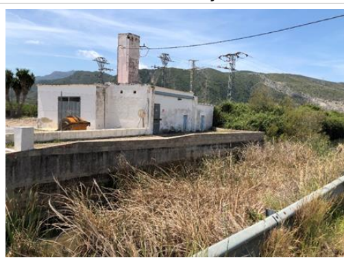
Foto 18. Caseta de bombeo nº 10
