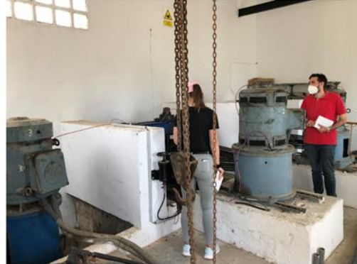
Foto 14. Bombas de caseta de bombeo nº 3
