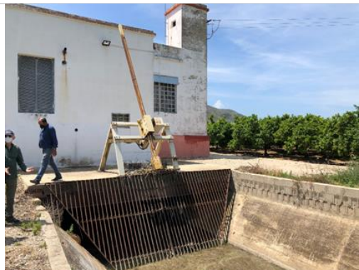
Foto 17. Caseta de bombeo nº 7
