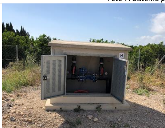
Foto 8. Hidrante de riego
