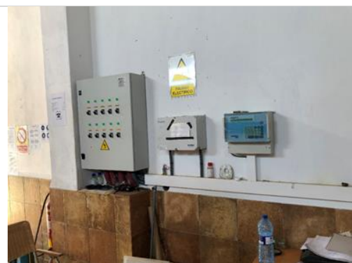
Foto 6. Cabezal de riego. Sistema de control
