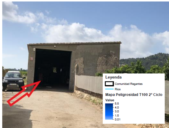
Foto 23. Posibles puntos de entrada de agua al almacén
