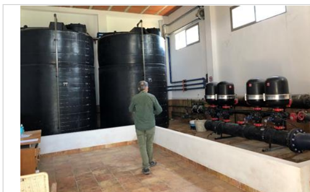
Foto 5. Cabezal de riego. Bombas y depósito de abonos
