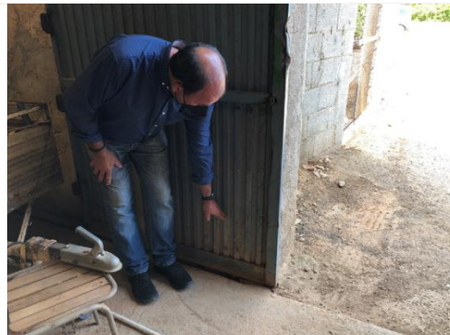
Foto 22. Altura que alcanzó el agua en la inundación
