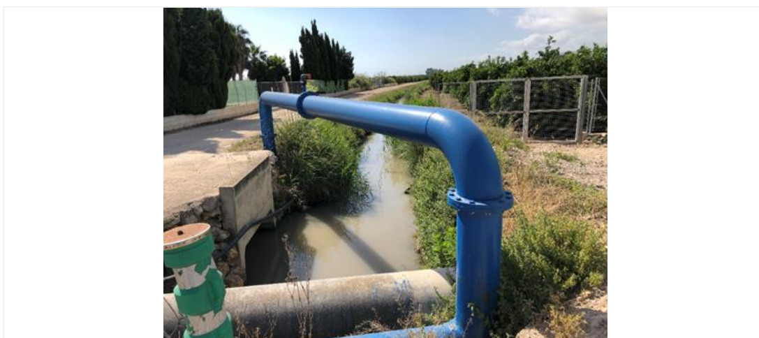
Foto 7. Sistema presurizado de riego
