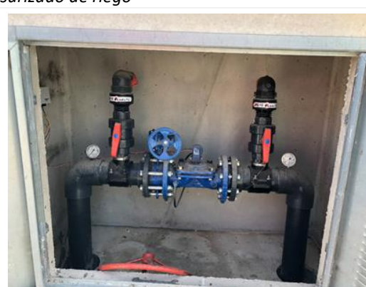
Foto 9. Hidrante de riego. Detalle
