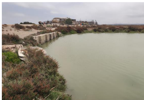
Foto 8. Salida oeste con clapetas
