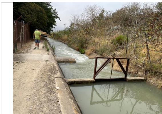
Foto 3. Canal de transporte a la salida del bombeo
