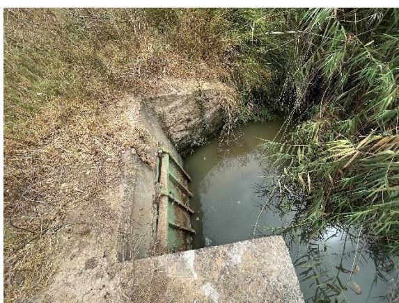
Foto 14. Arroyo Carrillo. Clapeta aguas abajo dique
