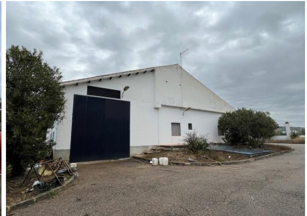
Foto 10. Entrada de agua por el lateral
