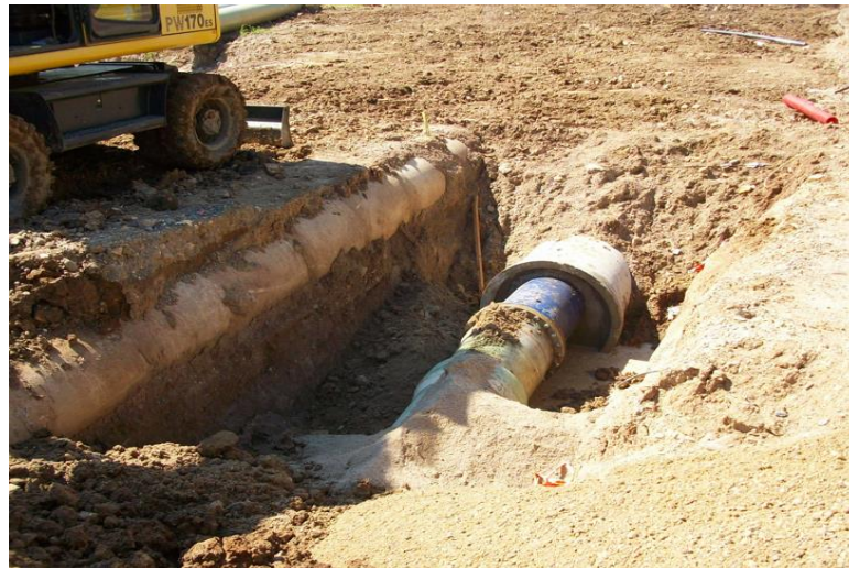
Foto 8. Socavación en el terreno producida por las inundaciones. Red de distribución
