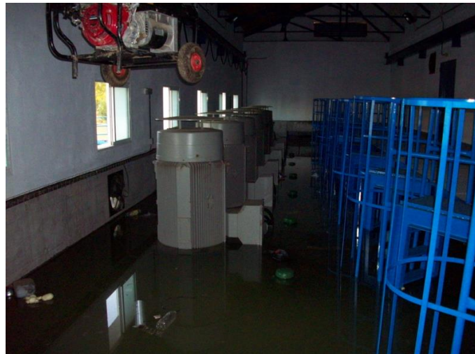
Foto 6. Altura del agua afectando a las motobombas
