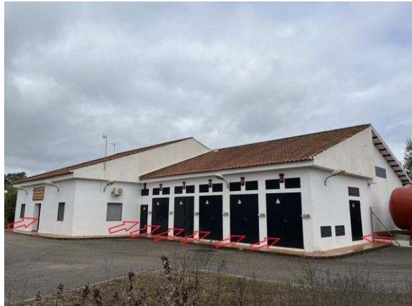
Foto 9. Entradas de agua por la fachada principal
