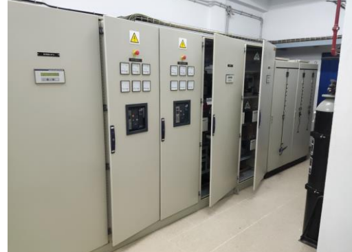
Foto 4. Centro de control
