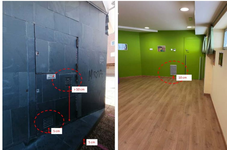
Figura 32. Rejillas de ventilación
