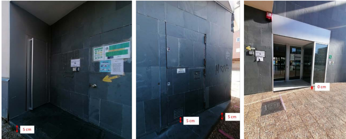
Figura 25. Accesos al edificio como puntos de entrada de agua
