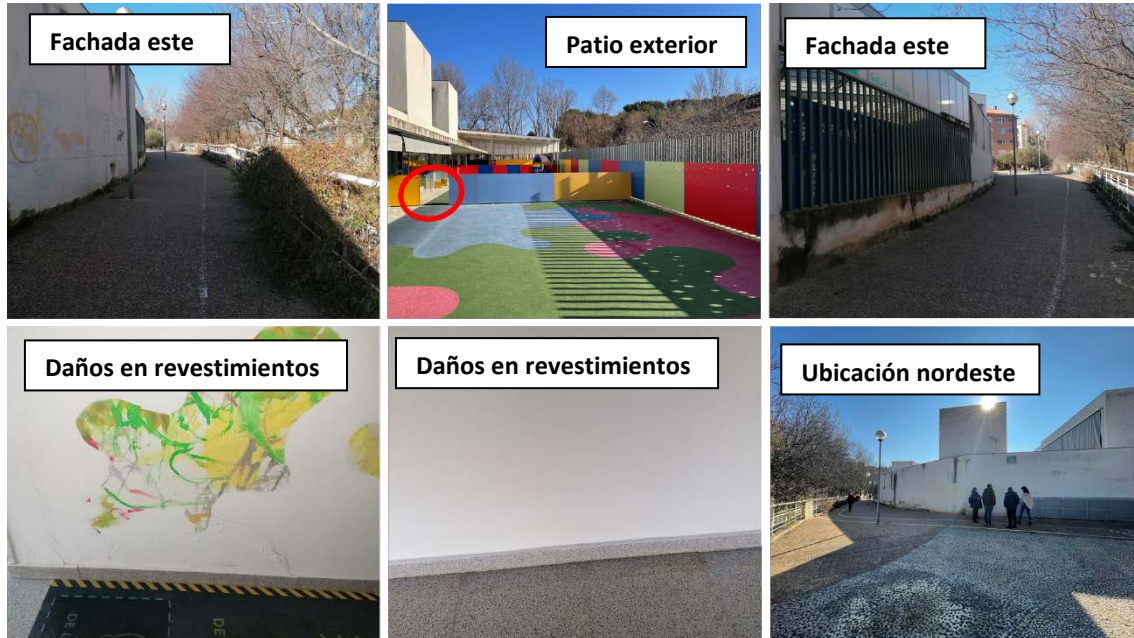
Figura 30. Humedades en los muros y paredes, así como el detalle de un panel del patio roto por las inundaciones
