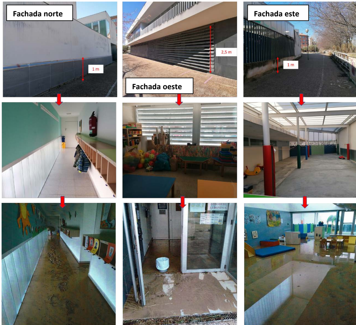
Figura 27. Ventanales a pasillos y patio interior central como puntos de entrada de agua
