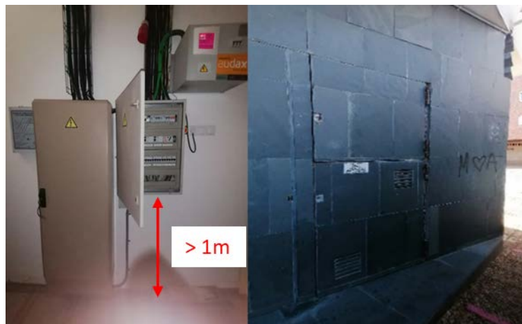
Figura 34. Suministro eléctrico ubicado en un cuarto con acceso desde el exterior, por la calle Bézquiz
