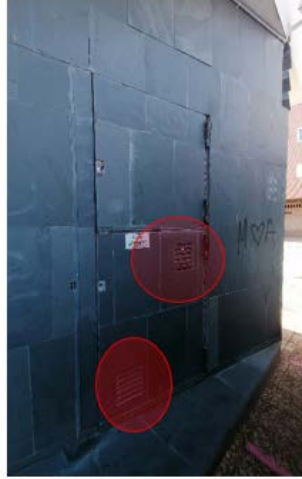
Figura 45. Protección en rejillas de ventilación
