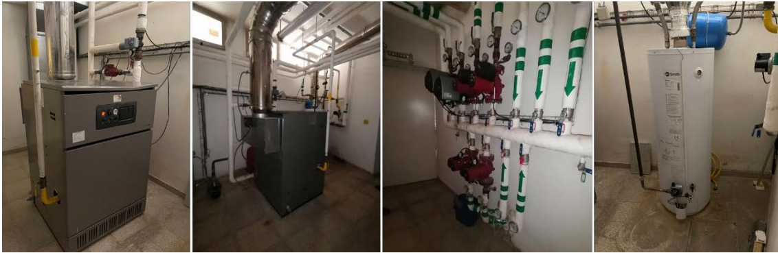
Figura 33. Calefacción y termo de agua caliente
