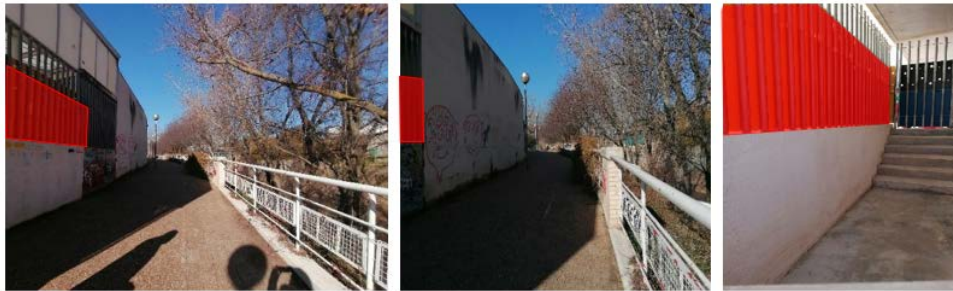
Figura 43. Muro existente a recrecer en patios exterior e interior, delimitante con la calle Bézquiz
