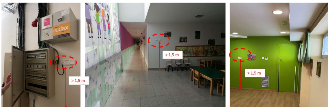
Figura 37. Enchufe situado en la entrada del edificio junto a los baños
