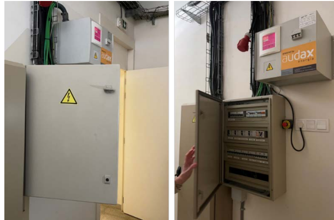
Figura 35. Cuadro eléctrico ubicado en la planta baja
