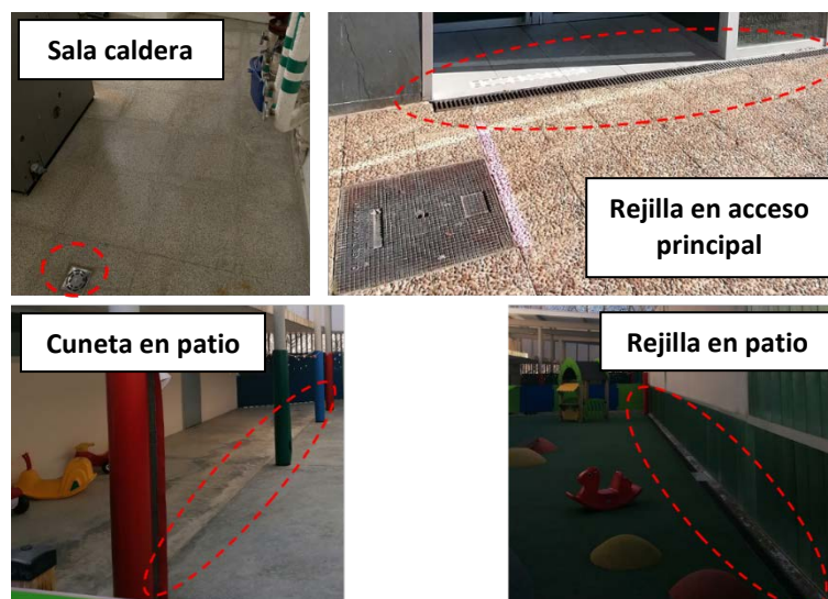
Figura 31. Arquetas de saneamiento
