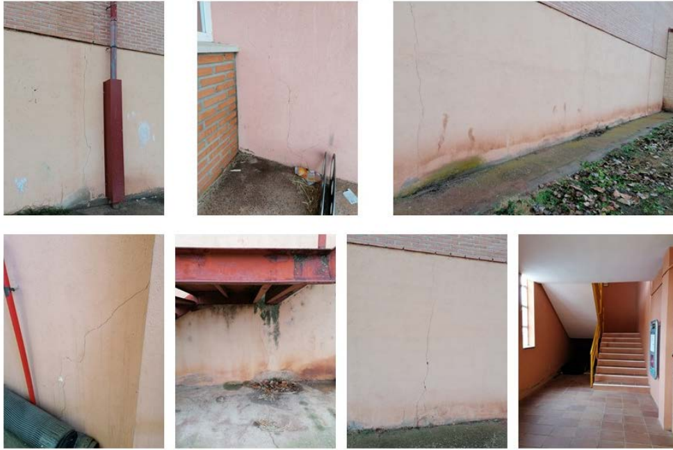
Figura 19. Detalle de grietas y humedades observadas tanto en el exterior como en el interior del pabellón en todos los paramentos del mismo
