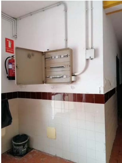
Cuadro eléctrico ubicado en la entrada NE
