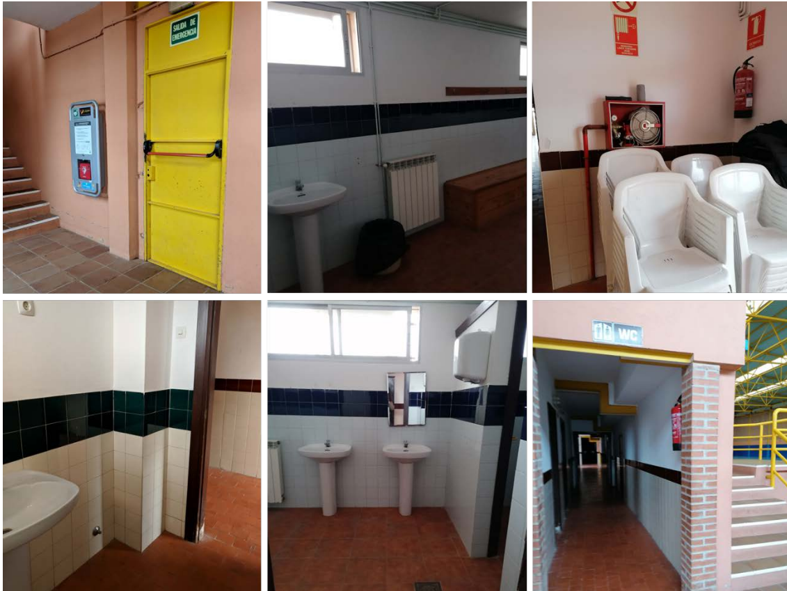
Figura 25. Contenido del pabellón: Baños, desfibrilador, equipo de extinción de incendios
