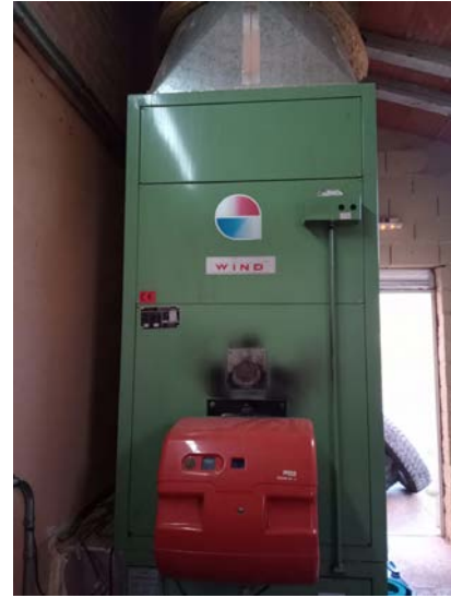
Detalle de la caldera
