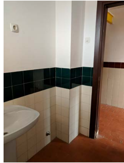
Detalle de los enchufes e interruptores elevados en los baños
