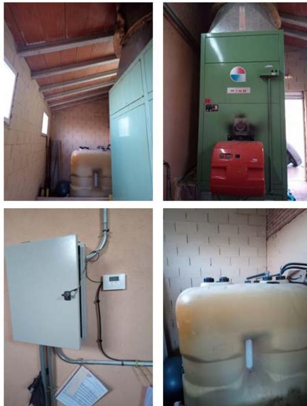
Figura 23. Cuarto de la caldera
