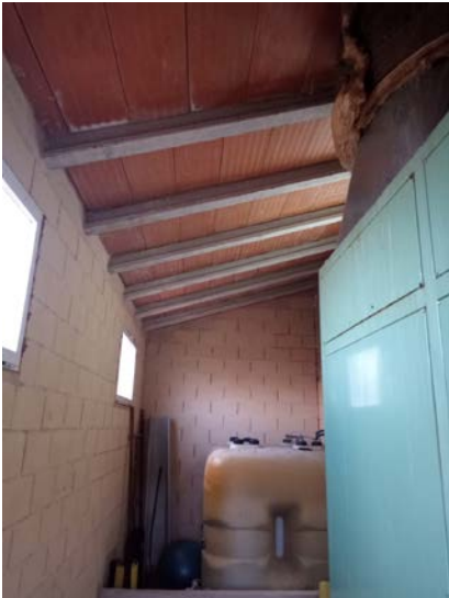
Vista del bidón de combustible para la caldera
