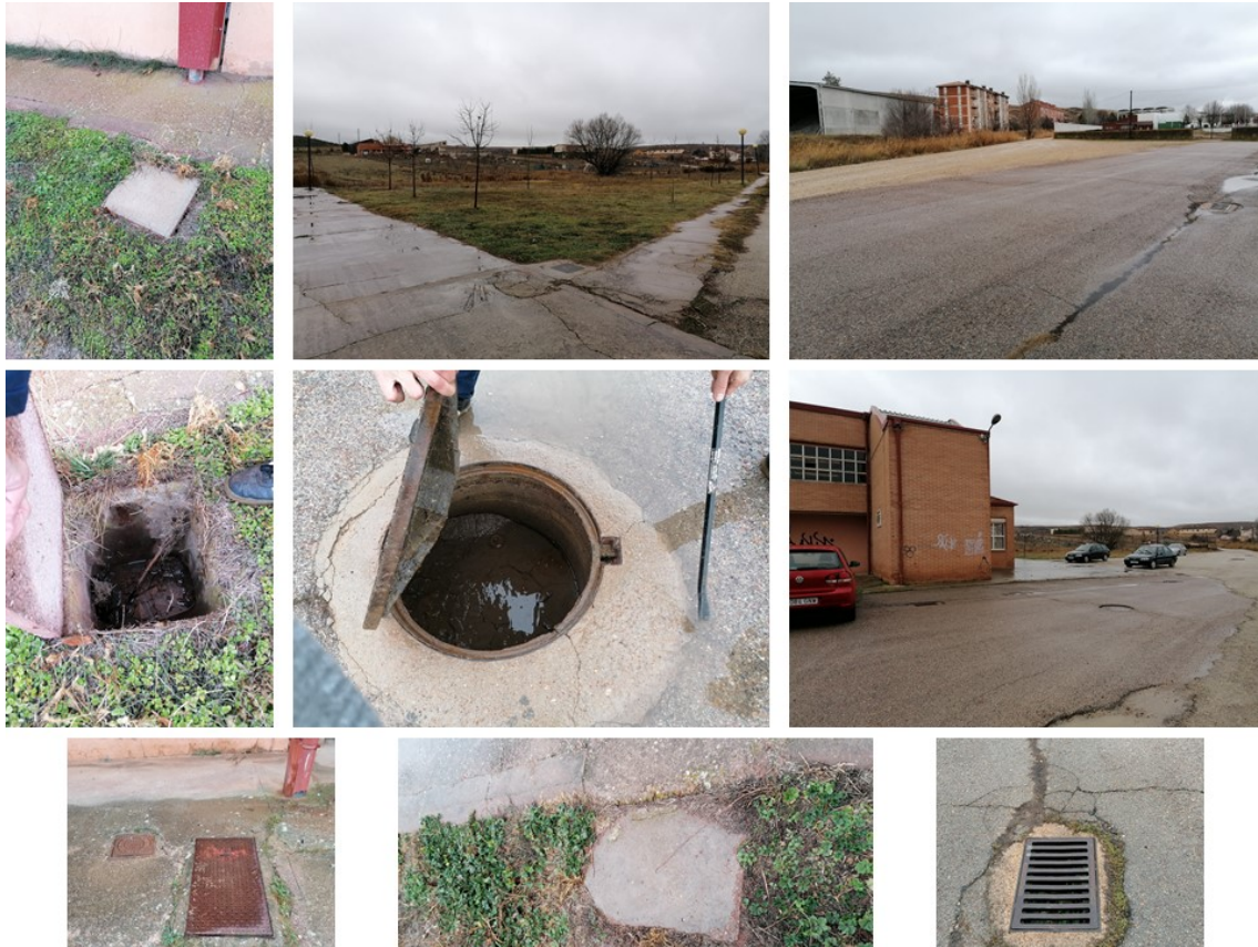
Figura 20. Arquetas y rejillas ubicadas en la parcela del pabellón
