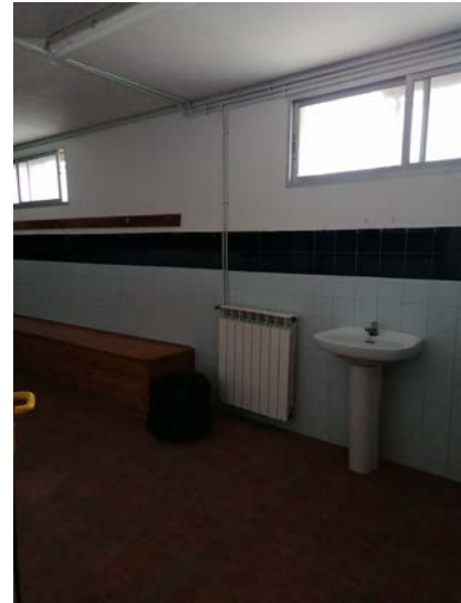
Mobiliario y calefacción en los baños/vestuarios
