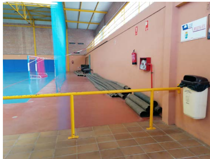
Lateral de la pista, extintor y manguera de incendios
