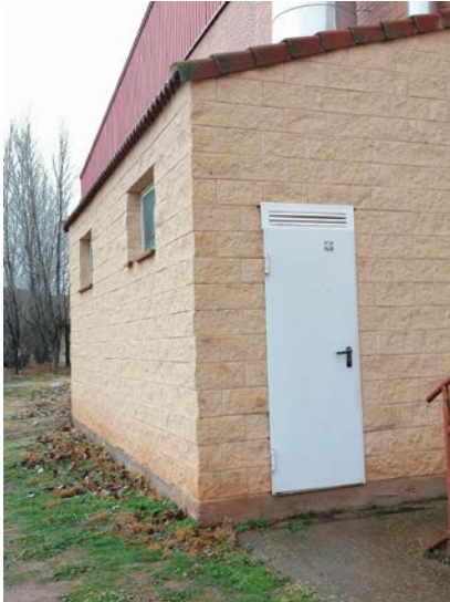
Acceso exterior al cuarto de la caldera
