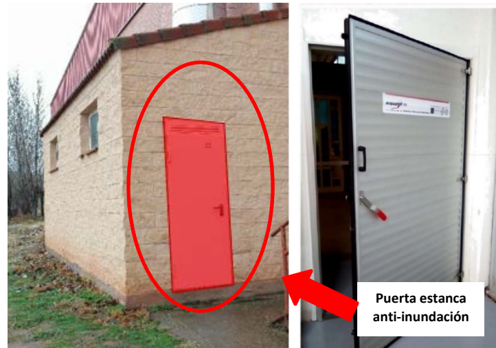
Figura 35. Puerta estanca en el acceso a cuarto de calderas
