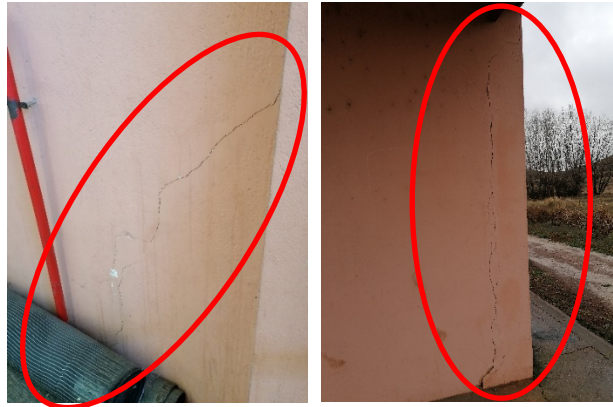
Figura 29. Grietas en fachada.
