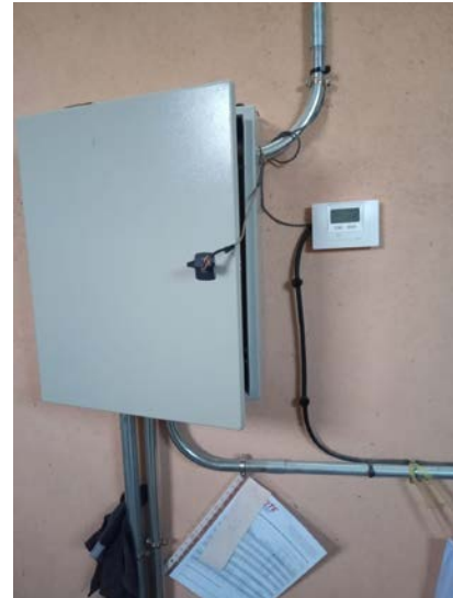
Cuadro eléctrico del cuarto de la caldera
