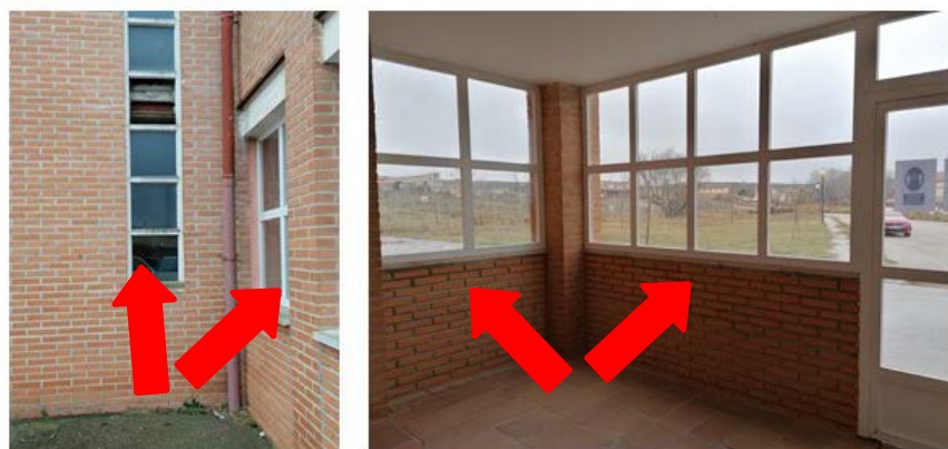
Figura 34. Vidrios de ventanales a sustituir. Acceso oeste y hall de entrada
