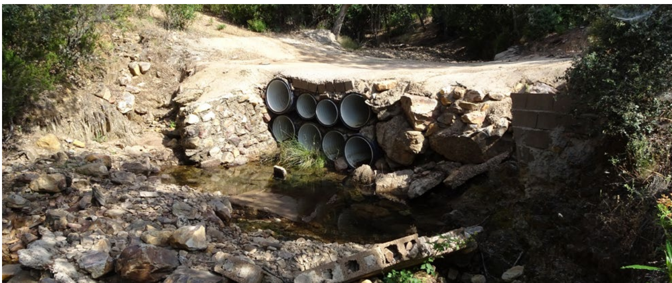
Canalización por tuberías en la reserva natural fluvial río Robledillo
