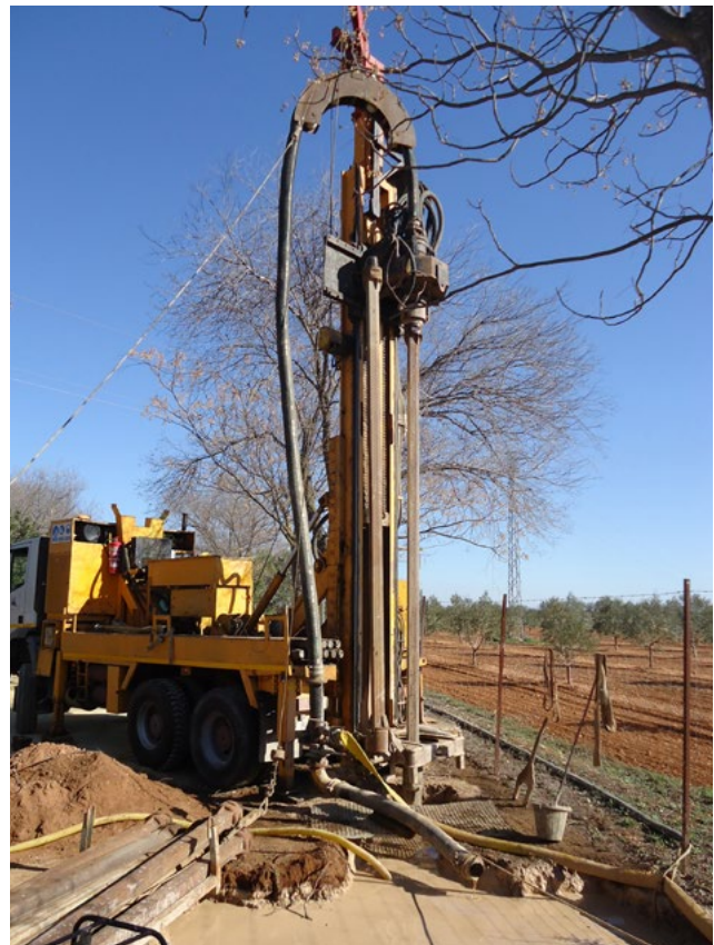
Piezómetro localizado en el municipio de Lantejuela, Sevilla
