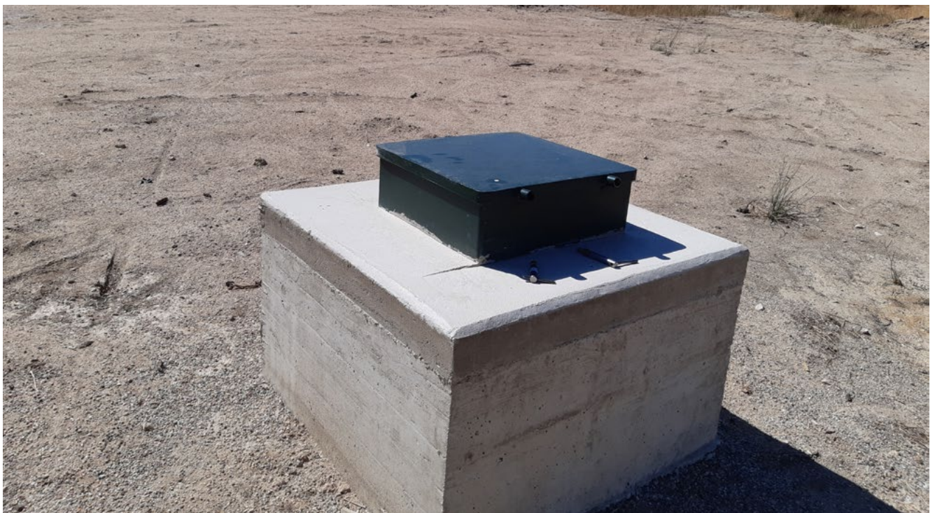
Arqueta de piezómetro en el municipio de Tres Cantos
