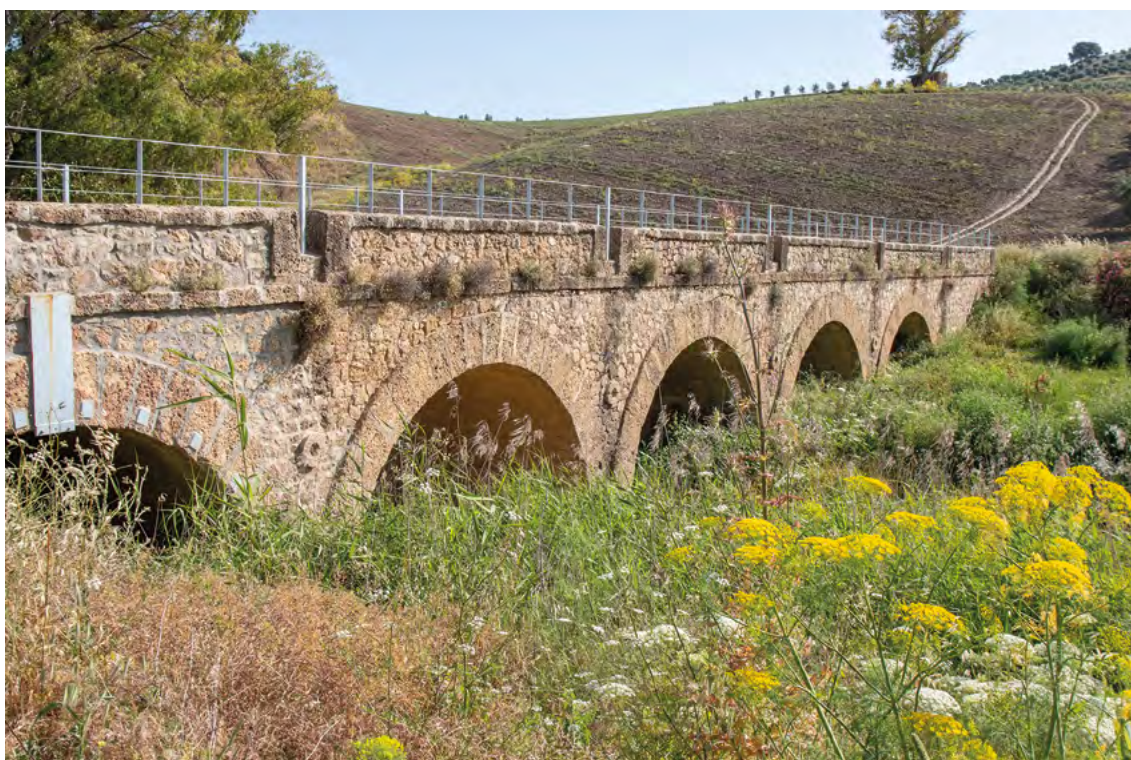
Puente en río Corbones, Villanueva de San Juan (Sevilla). Foto: Jacinto Román.
