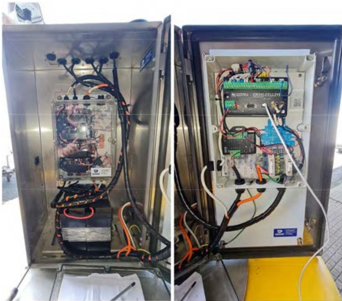
Figura 2-4 Los principales componentes eléctricos y electrónicos se integran en un armario de acero inoxidable A4/AIS316, de grado IP67 fabricado por la empresa delValle según diseño de SIDMAR.
