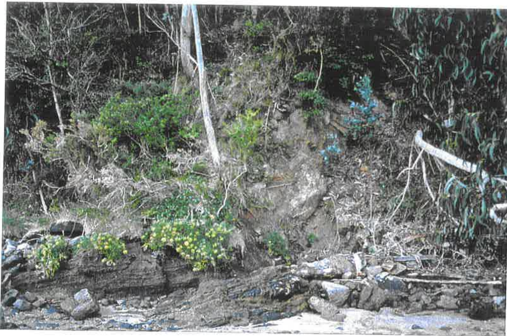
2.- Desprendimientos en el talud litoral ocasionados por la acción de las raíces de los eucaliptos.
