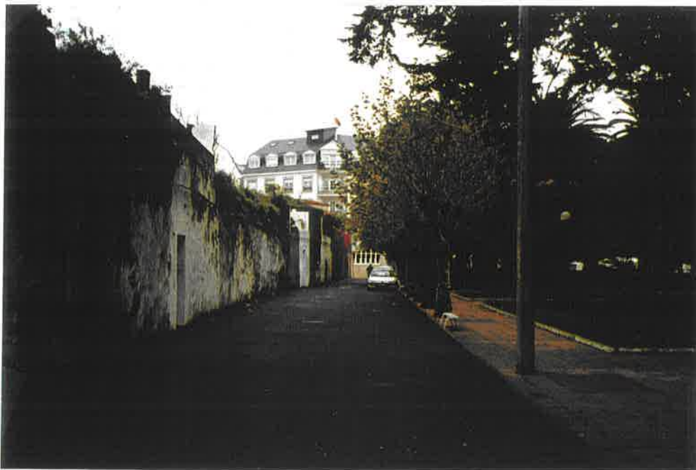
21.- Vial asfaltado y fachada frente al Jardín del Malecón . La fachada no está alineada con respecto al plano del suelo y se encuentra en avanzado estado de deterioro.
