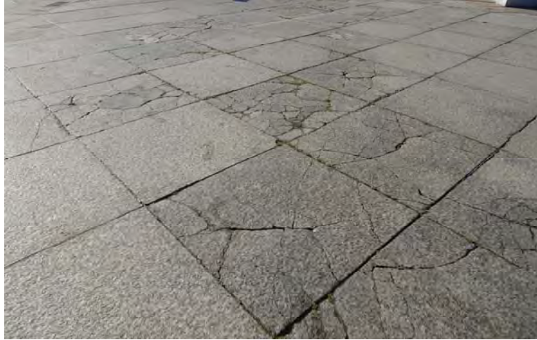
Figura 5: Estado actual del pavimento en la plaza sobre el Mirador
