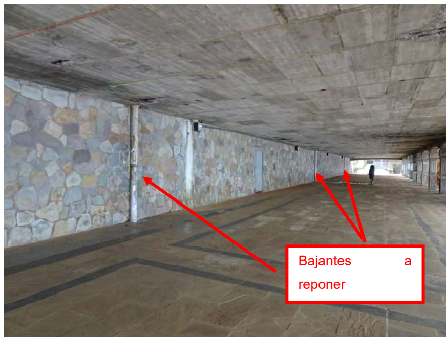
Figura 7: Bajantes a reponer en la zona inferior del Mirador
