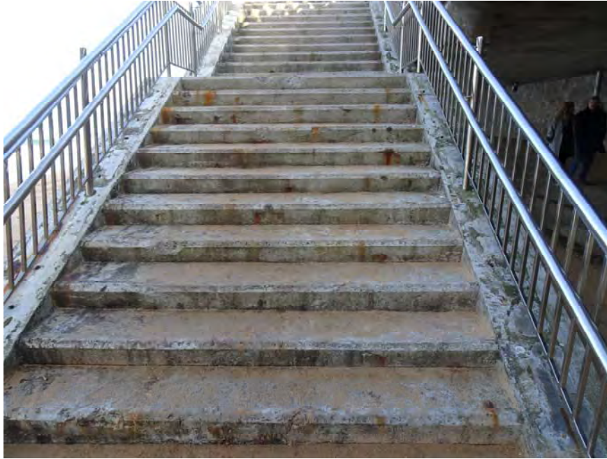
Figura 9: Estado actual de las escaleras de bajada al arenal
