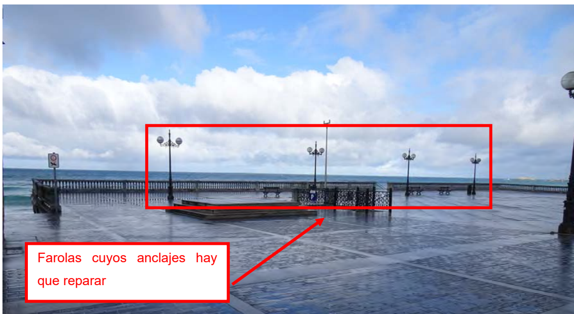
Figura 6: Farolas a reparar en la plaza sobre el Mirador
