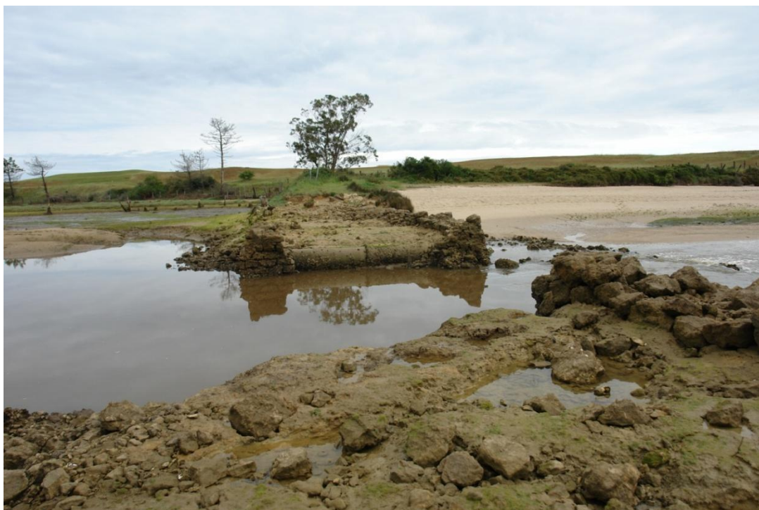
Ilustración 5. Estado actual del dique.
