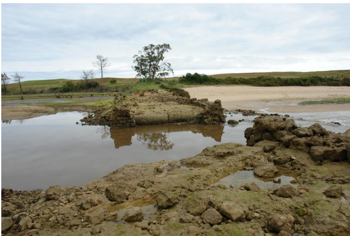
Ilustración 11. Falta de continuidad del dique.
