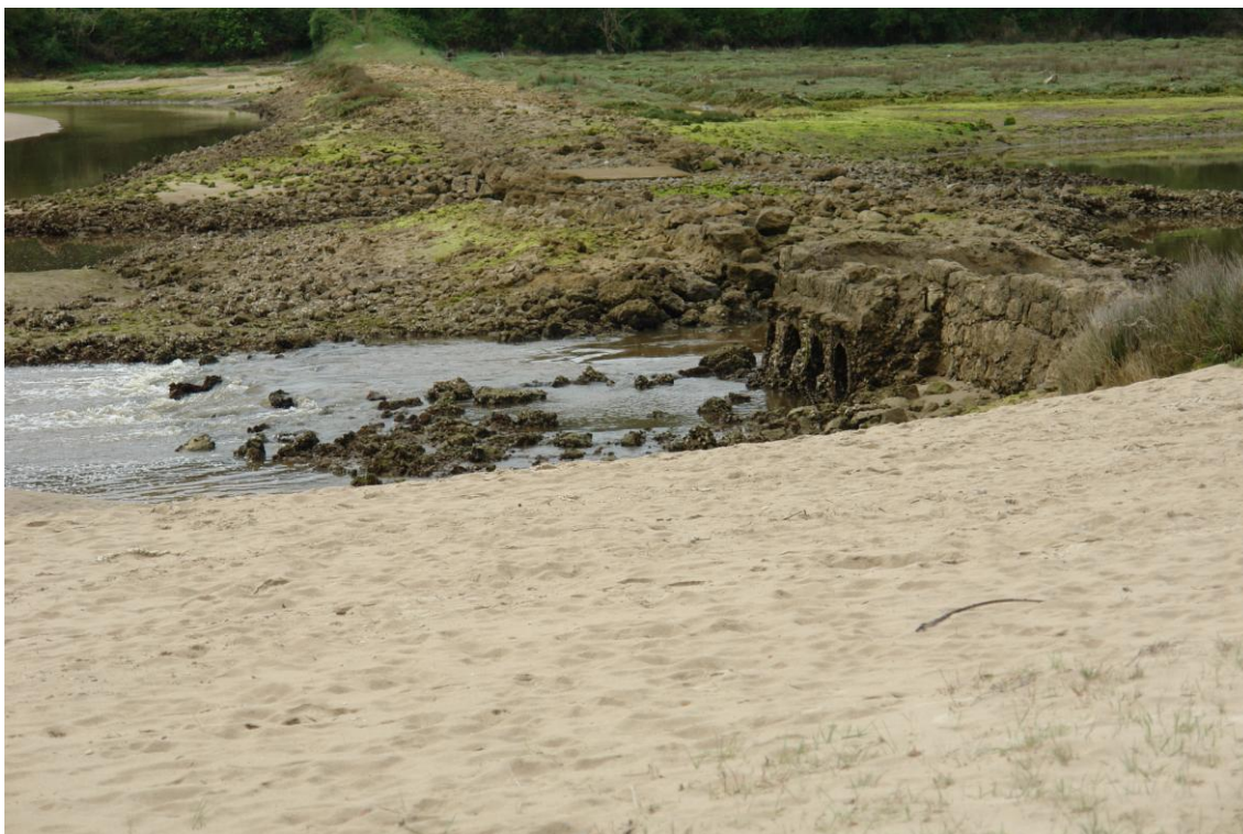
Ilustración 2. Tubos bajo el dique.
