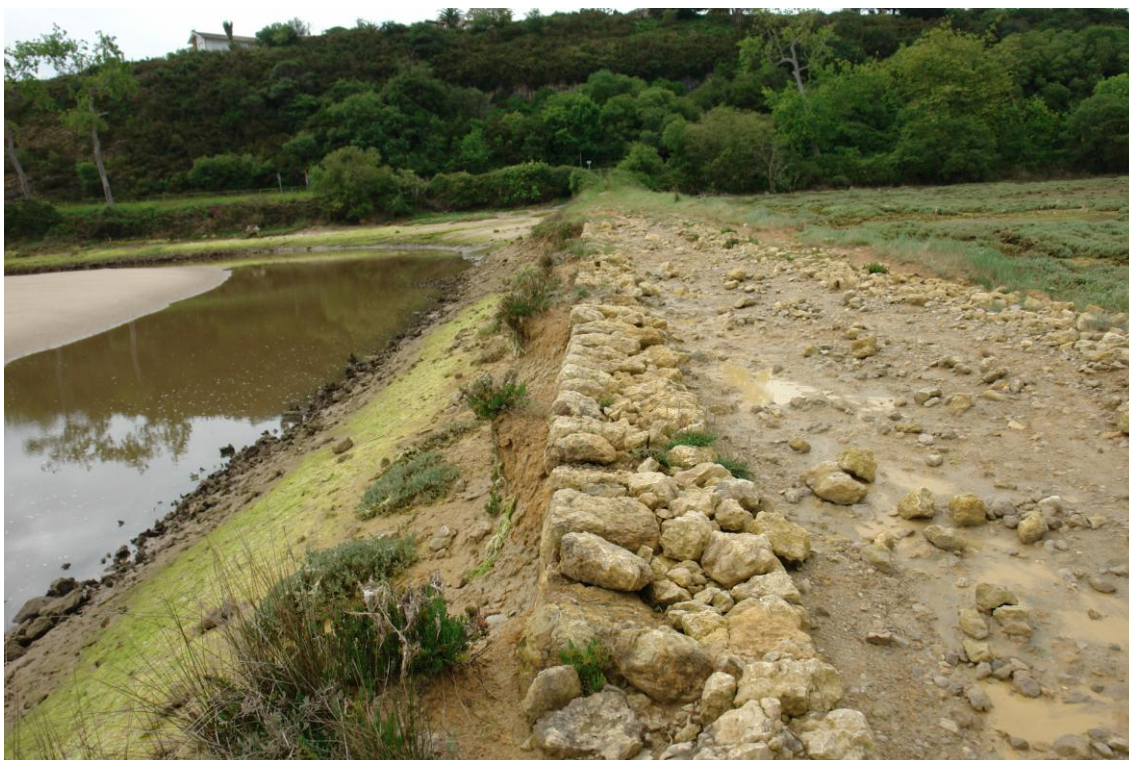
Ilustración 14. Estado actual del dique.
