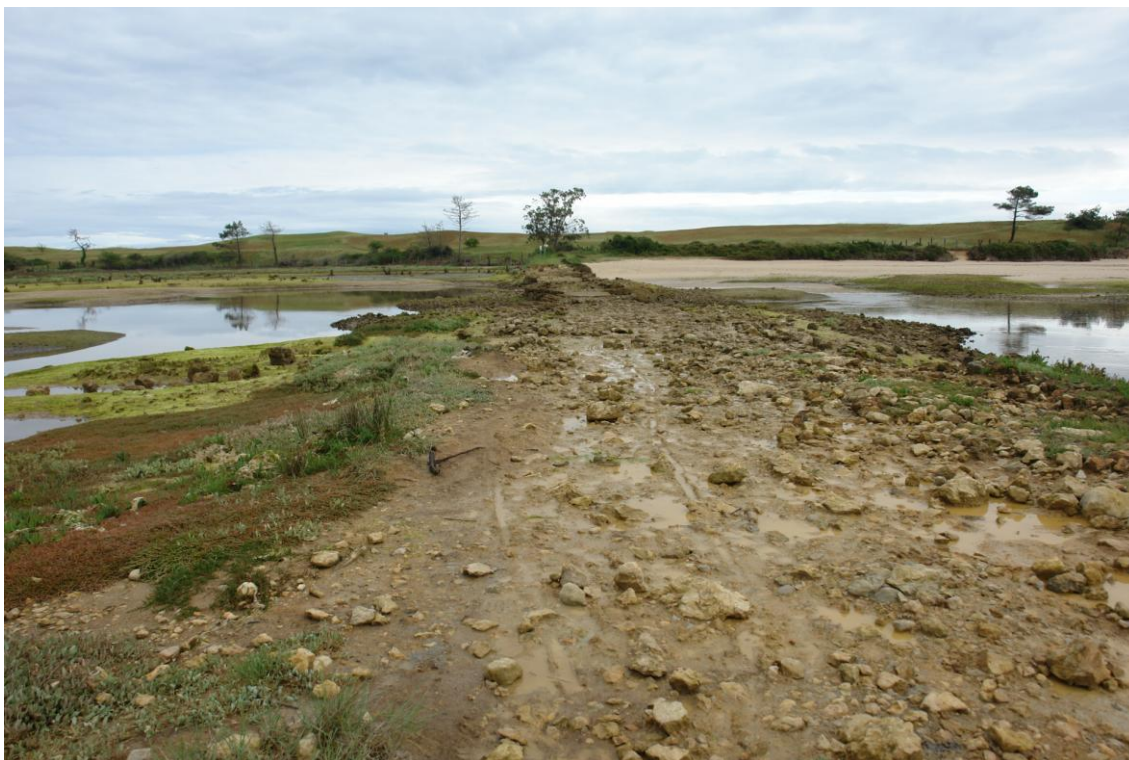
Ilustración 6. Estado actual del dique.
