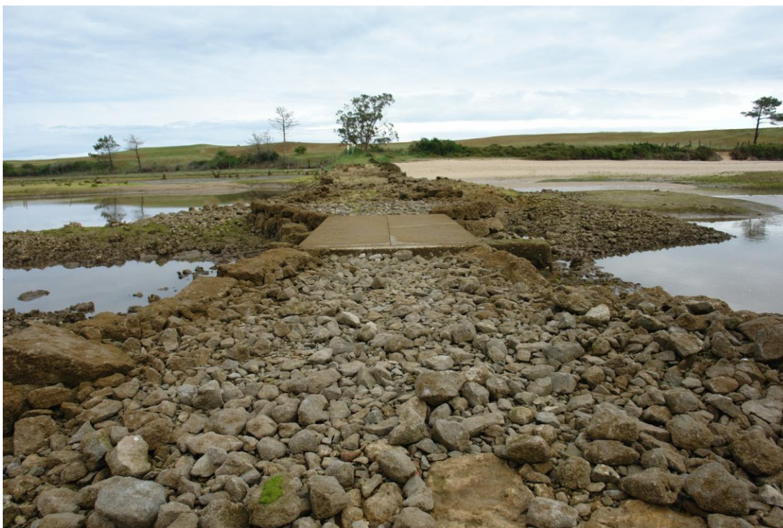
Ilustración 9. Estado actual del dique.
