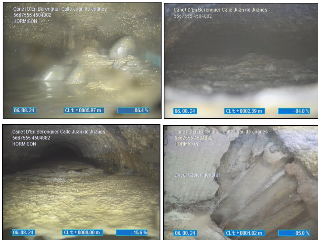
Patologías existentes en la red de colectores y acequias
