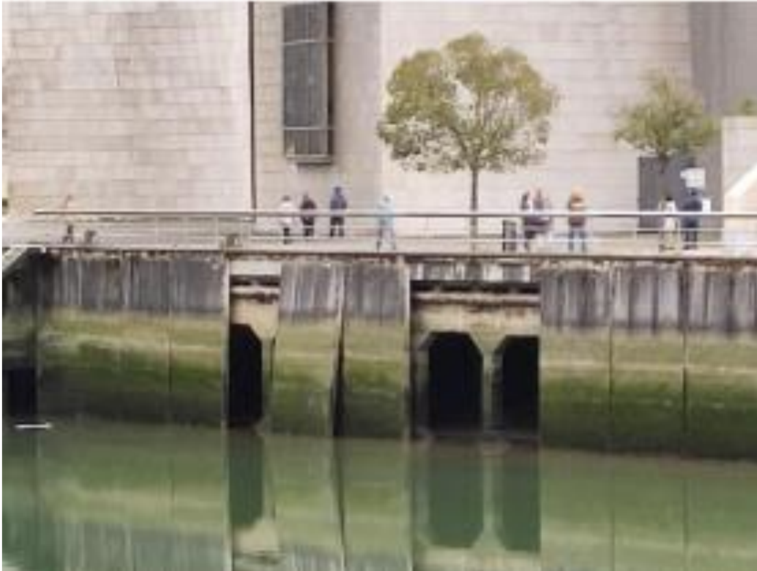
Figura 2. Detalle de las zonas del muelle en las que deben ser instaladas las nuevas placas.
