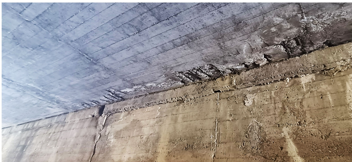
Ilustración 4. Afeción sobre el muro el apoyo central.
