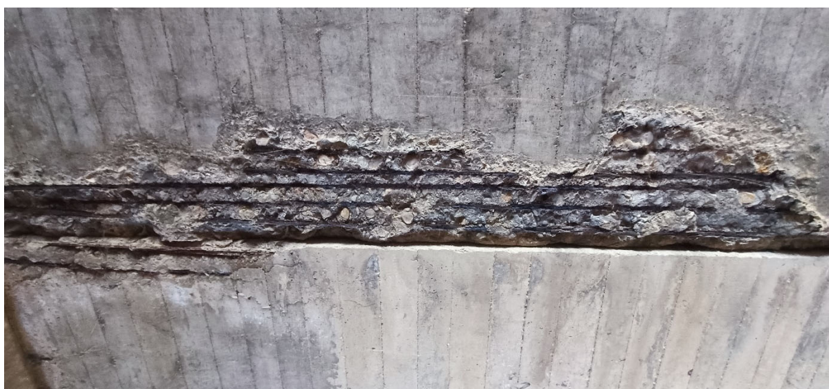
Ilustración 5. Afeción en el eje longitudinal del puente.
