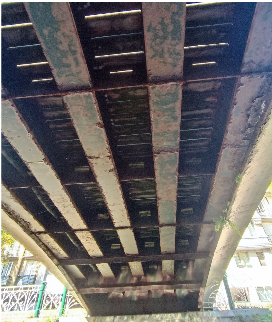
Ilustración 2. Estado actual de la parte inferior de la pasarela.
