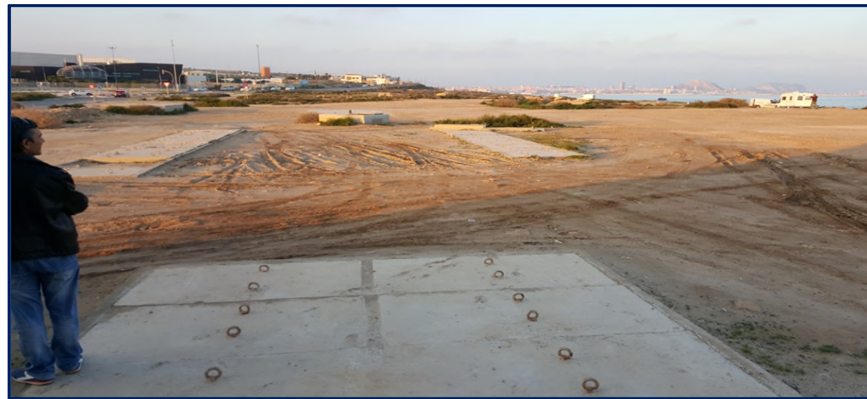
Fotografía 8. Instalaciones de la desaladora. Elaboración propia.
