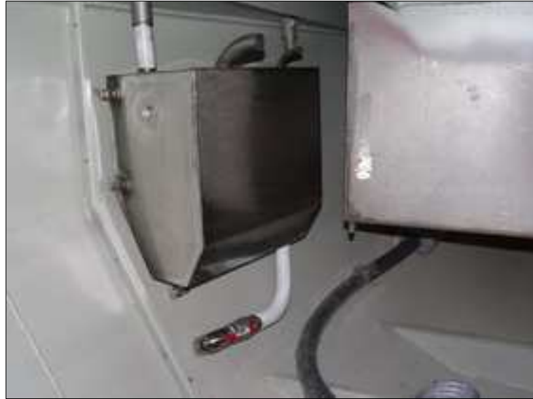
Figura 15. Tanque y tuberías de aguas negras
