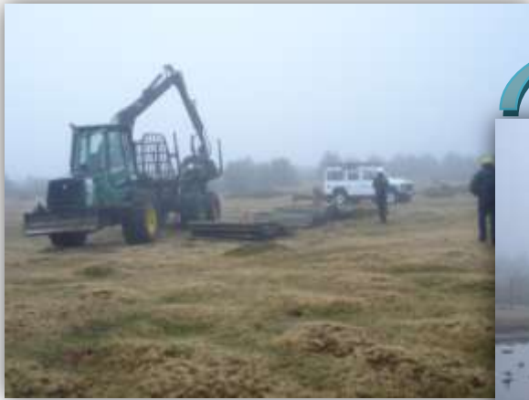
Inicio de la actuación con el acopio de material, y colocación de los postes
