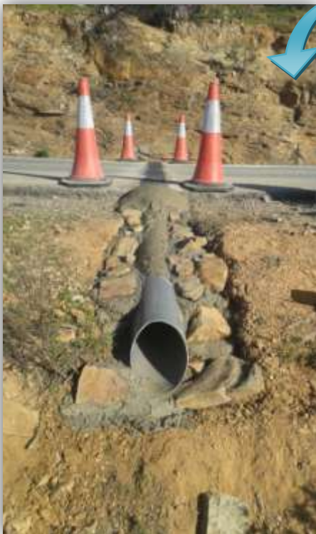
Tubo de PVC para evitar atascos en zona no asfaltada
