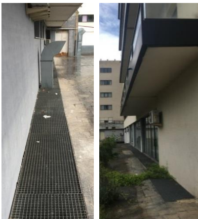
Fig. 16 Rejillas en encuentro con edificio
