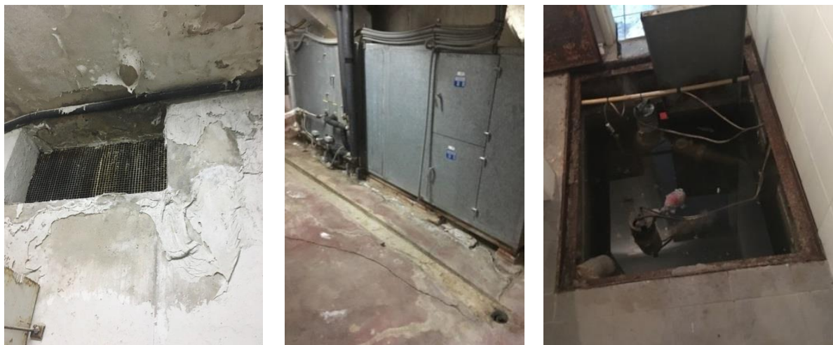
Fig. 21 Humedades en paso de ventilación, canalización en suelo, y punto de bombeo.
