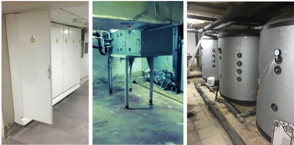
Fig. 23 Armario CGBT elevado, aparato de clima elevado y Sala de bombas y depósitos ACS con canalizaciones en suelo.
