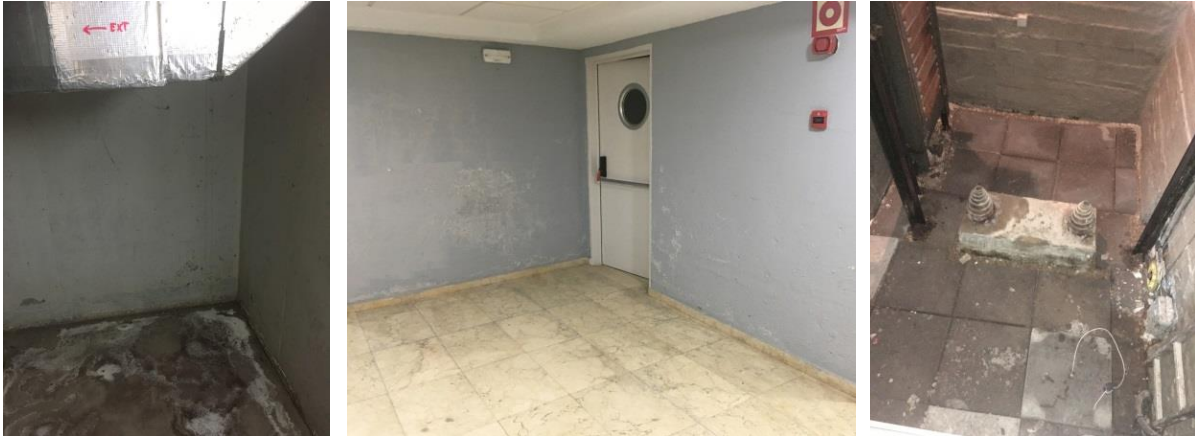
Fig. 22 Humedades en suelo, paredes y foso de ascensor.
