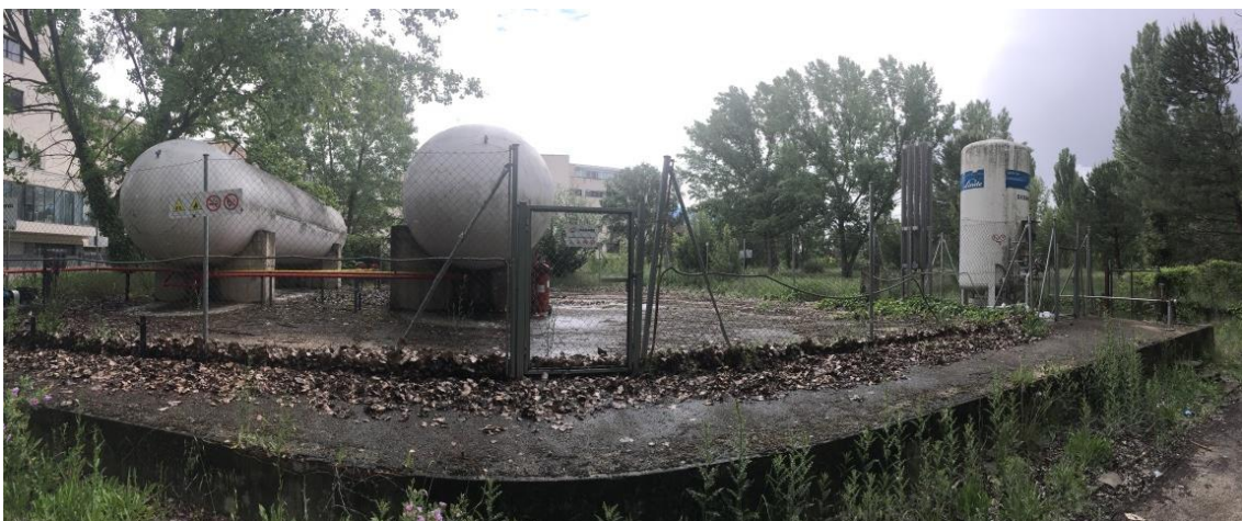
Fig. 14 Depósitos de oxígeno y gasoil sobre plataforma elevada.
